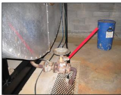
Figura 3.6. Purga descontínua da caldeira.
