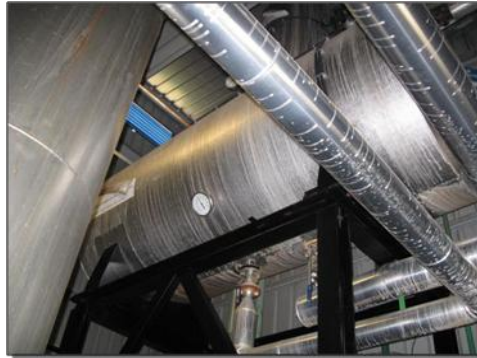
Figura 1.15. Fotografia do equipamento de desgaseificação.
