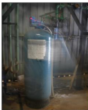
Figura 1.12. Fotografia da unidade de permuta iónica existente na Petibol.
