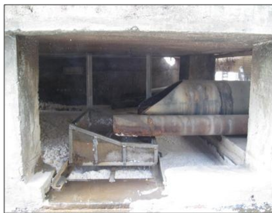
Figura 1.26. Saída de água de arrefecimento para o tanque de água quente.
