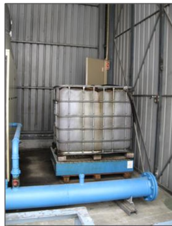
Figura 1.24. Armazenamento da água contendo óleo lubrificante.
