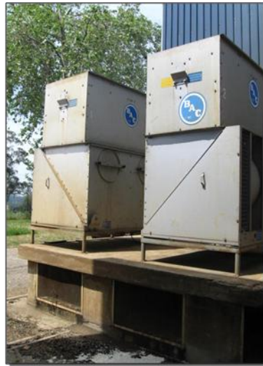
Figura 1.25. Fotografia das duas torres de arrefecimento.
