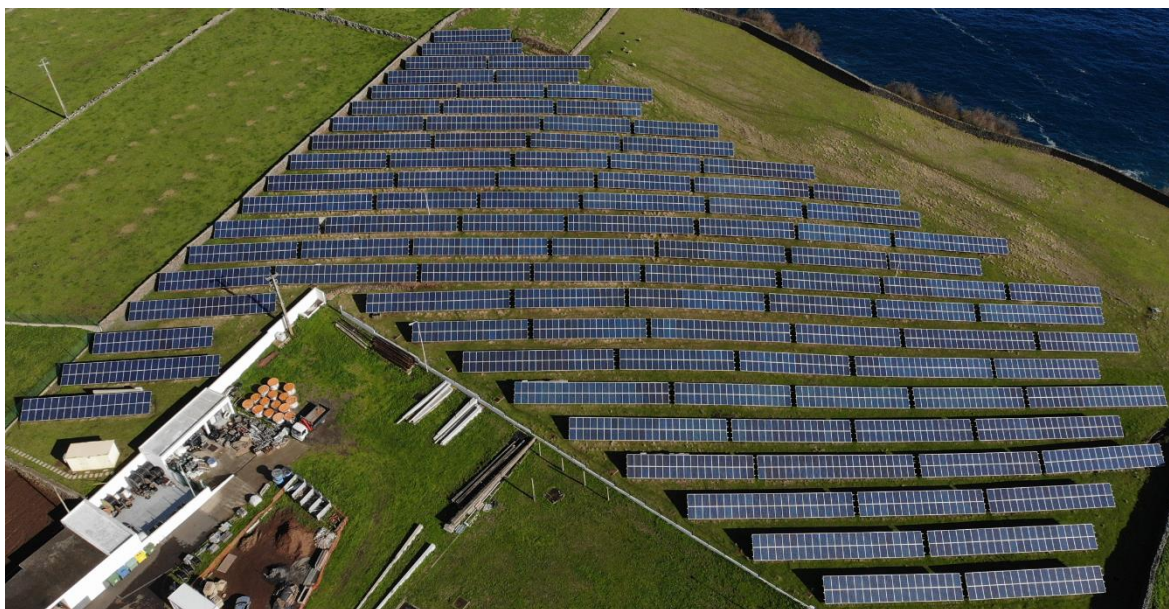
Figura 32 - Fotografia captada por drone, do parque solar instalado na ilha Graciosa
