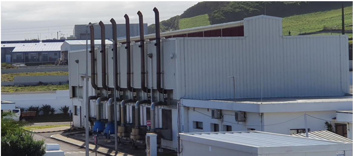
Figura 37 - Fotografia da Central Termoelétrica da Graciosa
