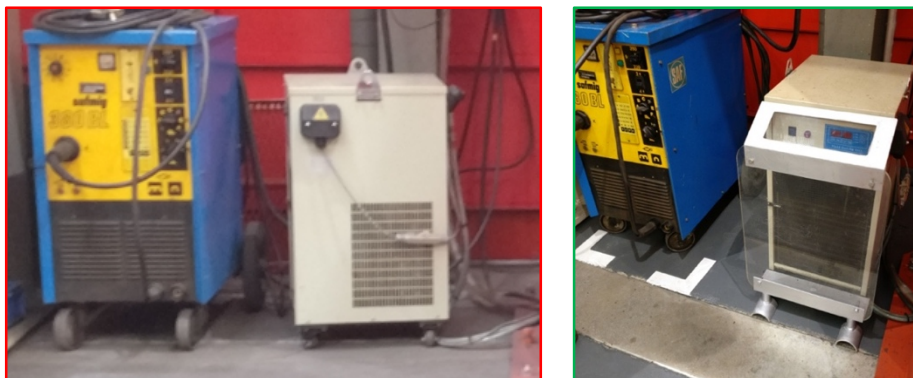
Figura 50 – [A] Gerador (antes) [B] Gerador (depois).
