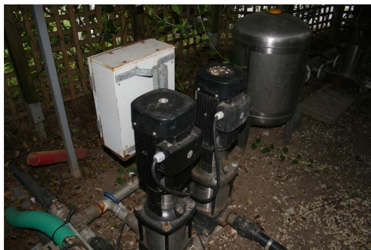
Figura 31: Bombas para o sistema de rega.
