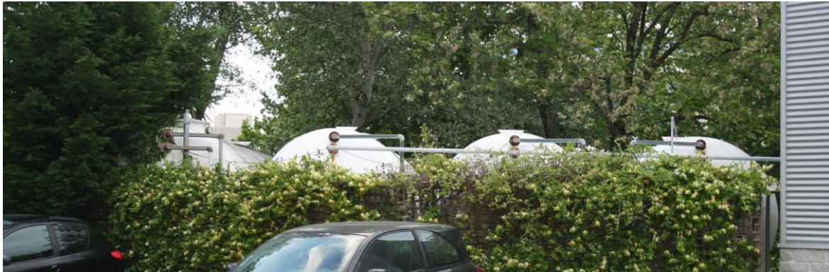
Figura 28: Quatro reservatórios de água
