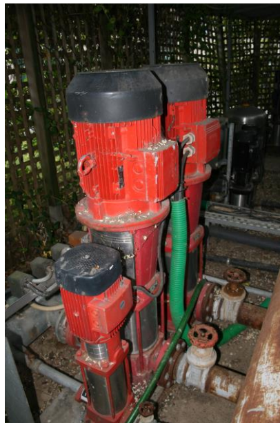
Figura 29: Bombas de incêndio
