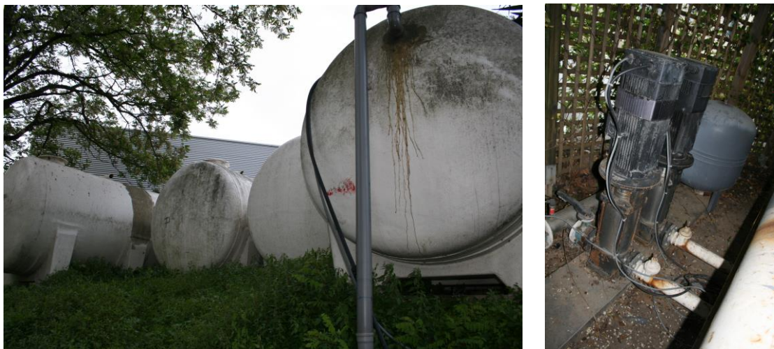
Figura 27: Reservatórios de água e bombas de extração de água dos fossos dos elevadores.
