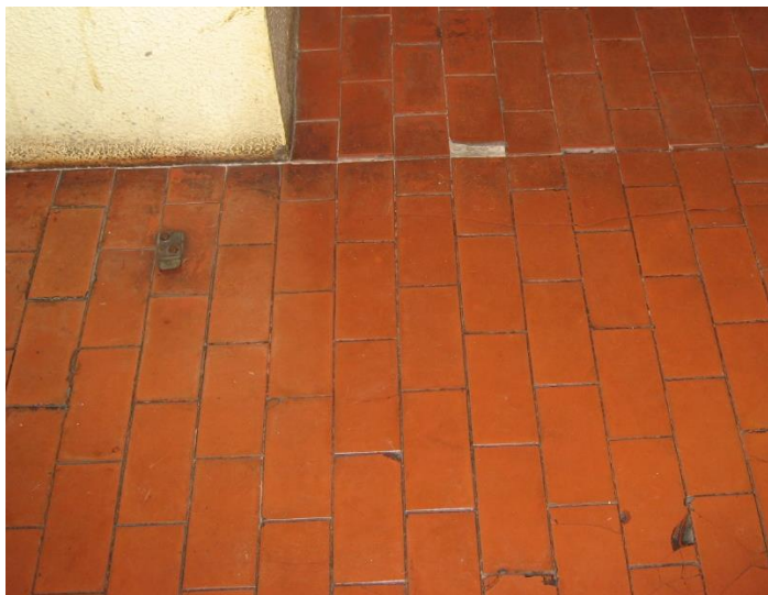
Figura 2.11 – Exemplos de fratura e ausência de cerâmico em zona de circulação comum, Bairro de São Gonçalo
