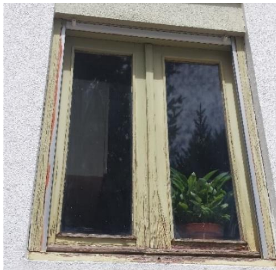
Figura 4.16 – Solução tipo de vão envidraçado – Pré intervenção
