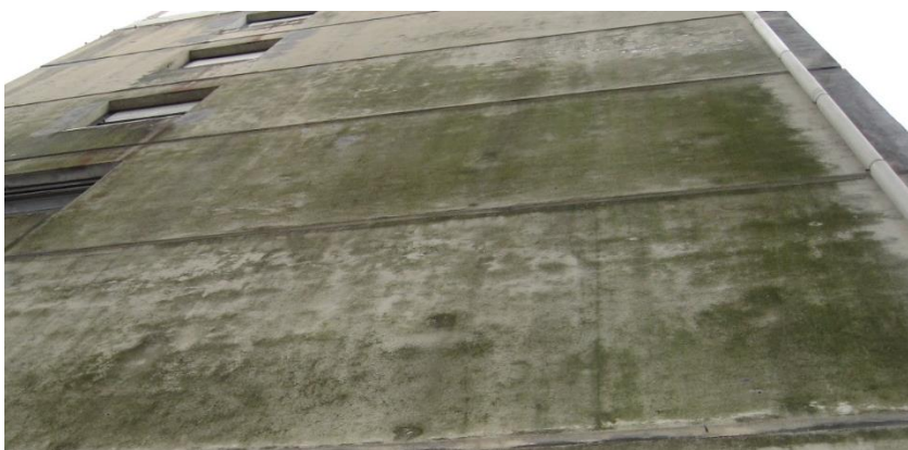
Figura 2.9 – Exemplos de ataque de fungos, Bairro de São Gonçalo
