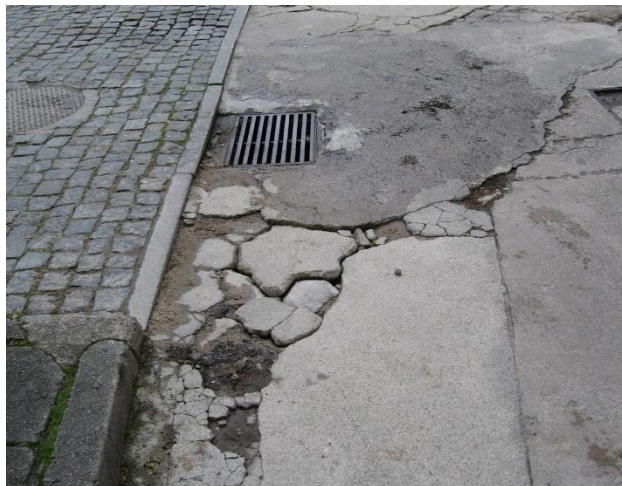
Figura 2.14 – Exemplos de degradação dos arranjos exteriores, Bairro de São Gonçalo
