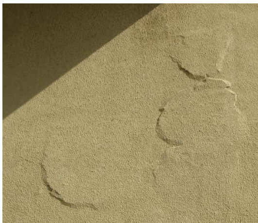
Figura 2.4 – Exemplo de delaminação/Bolhas na pintura, Edifício Nova Póvoa
