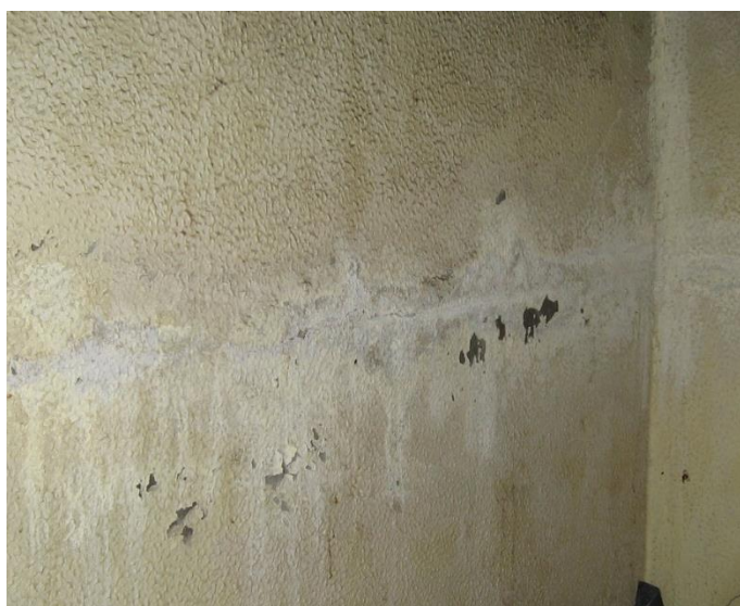
Figura 2.12 – Exemplos de degradação de paredes em zona de circulação comum, Bairro de São Gonçalo
