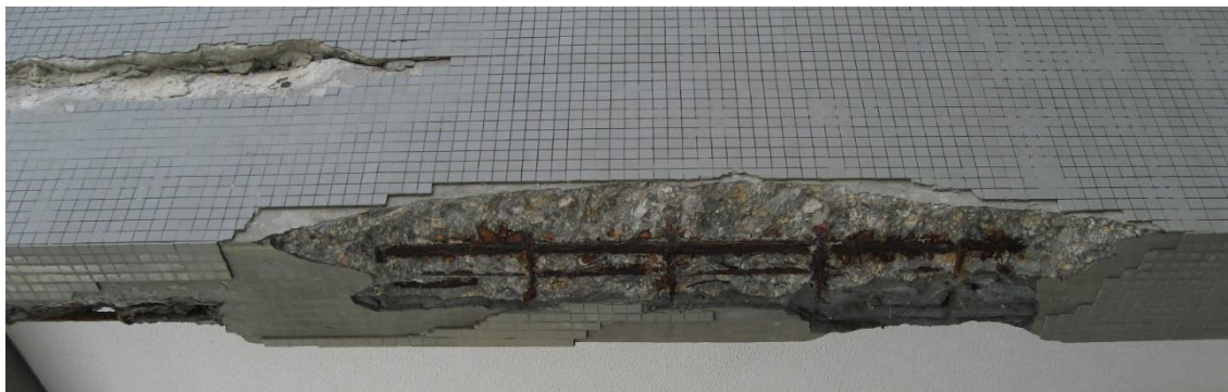
Figura 2.2 – Viga com armadura exposta, Edifício Sopete
