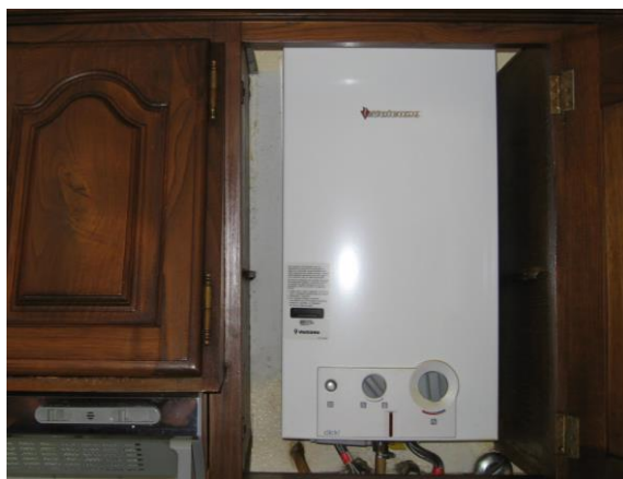
Figura 4.17 – Solução tipo para preparação de AQS – Pré intervenção
