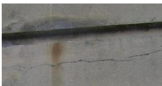
Figura 2.8 – Exemplos de fissuras e pontos de corrosão, Bairro de São Gonçalo
