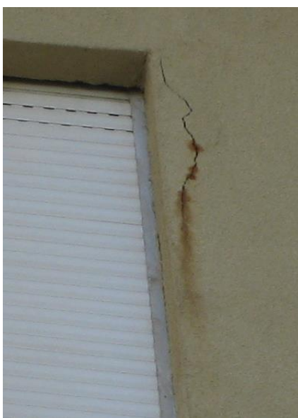
Figura 2.5 – Exemplo de fissura com corrosão da armadura, Edifício Nova Póvoa
