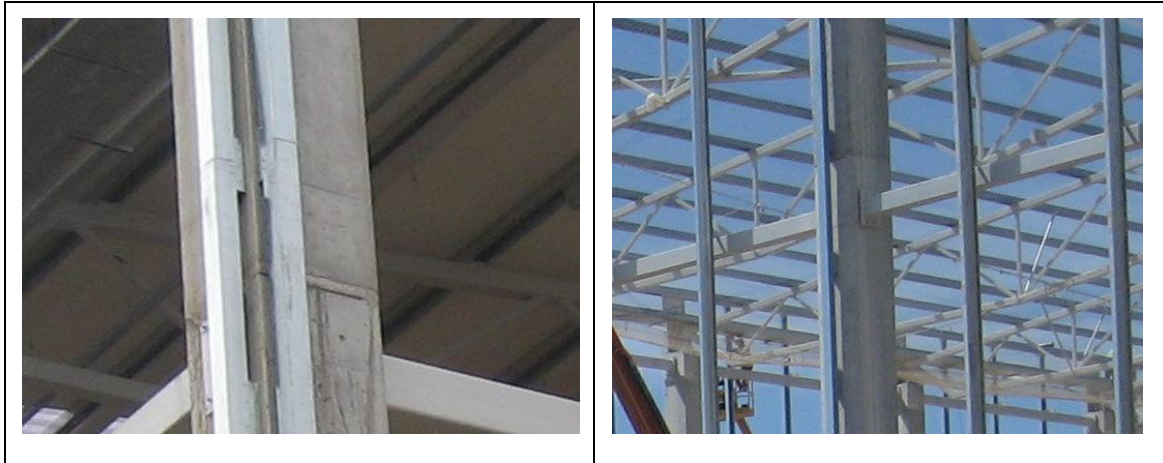
Fig. 60 Perfis em U sobrepostos utilizados para fixação dos painéis de fachada na zona dos pilares.
