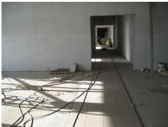
Fig. 28 Revestimento cerâmico em pavimentos.
