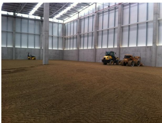
Fig. 77 Escarificação do terreno para criar aderência à 2ª camada da base do pavimento.
