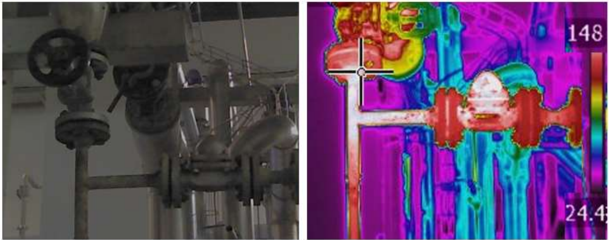
Figura 5.13 – Imagem fotográfica (esquerda) e termográfica (direita) do conjunto de purga de linha do vapor que aquece o CIP na área do arrefecimento do mosto, com passagem direta de vapor
