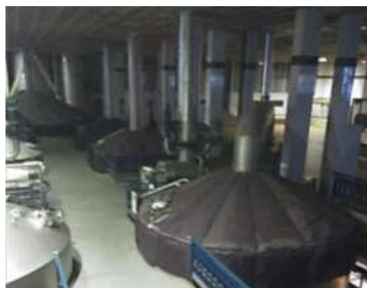
Figura 5.11 – Isolamento térmico das caldeiras de fabrico do mosto (imagem gentilmente cedida pelo Engenheiro Pedro Frias)
