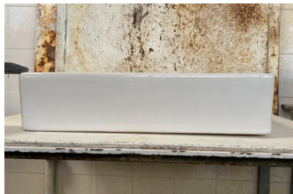
Figura 3.2 - Lavatório com empeno superior a 3 mm.
