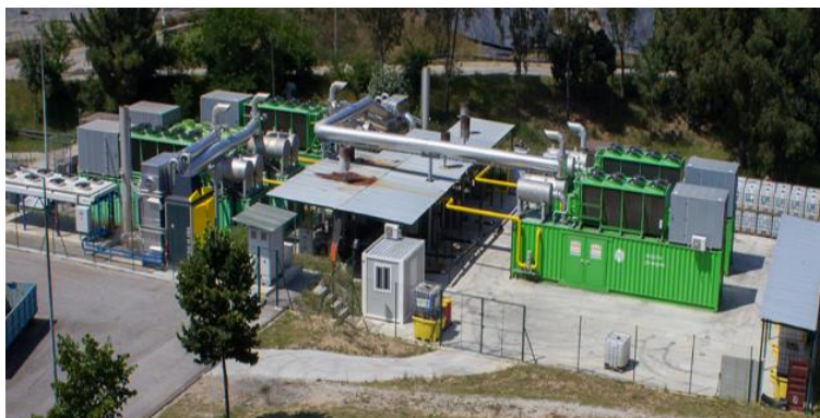
Figura 3.2 - Central de valorização energética (Suldouro, 2015)
