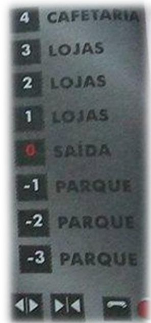
Fig. 1 - Quadro de elevador
