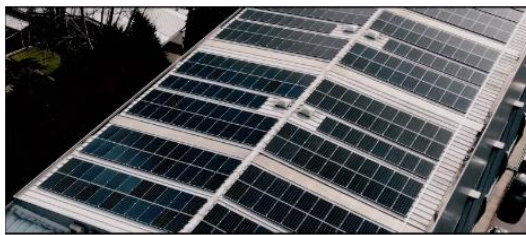
Figura 46 - Painéis solares fotovoltaicos instalados nas instalações da JNF
