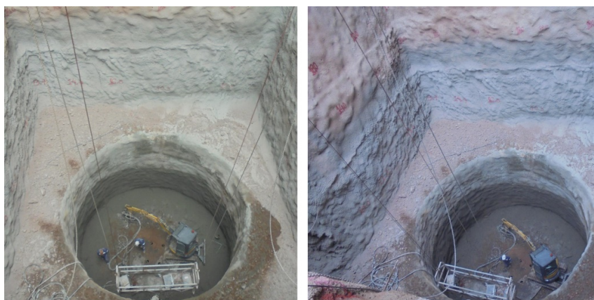
Figura 54. Preparação da projeção no interior do poço (arquivo de fotos EPOS SA; com autorização).
