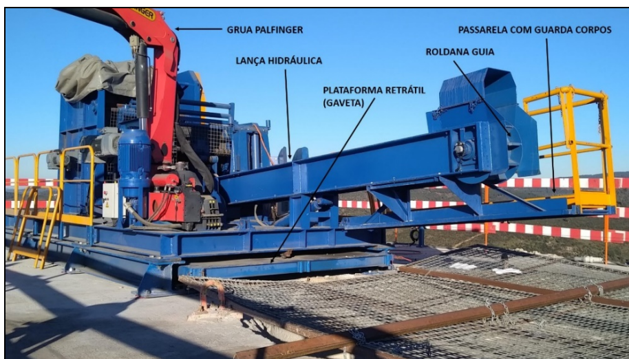
Figura 8. Plataforma técnica com grua, lança e roldana guia, passarela e plataforma retrátil (adaptado do arquivo de fotos EPOS SA; com autorização).
