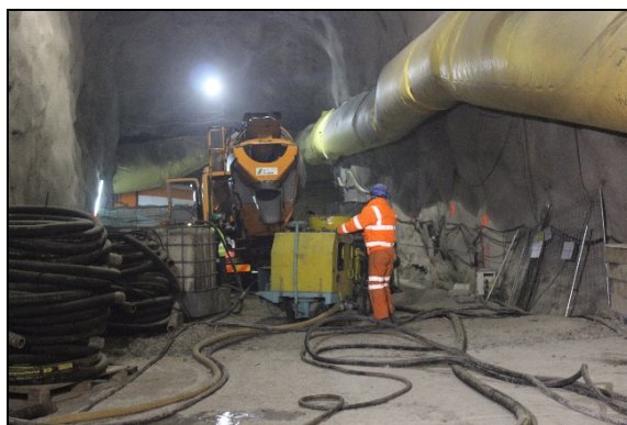
Figura 60. Local de descarga da autobetoneira (arquivo de fotos EPOS SA; com autorização).
