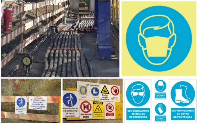
Figura 44. Extintor, linha de vida, dispositivo anti queda retrátil, guarda corpos, arrumação do material e sinalética (arquivo de fotos EPOS SA; com autorização).
