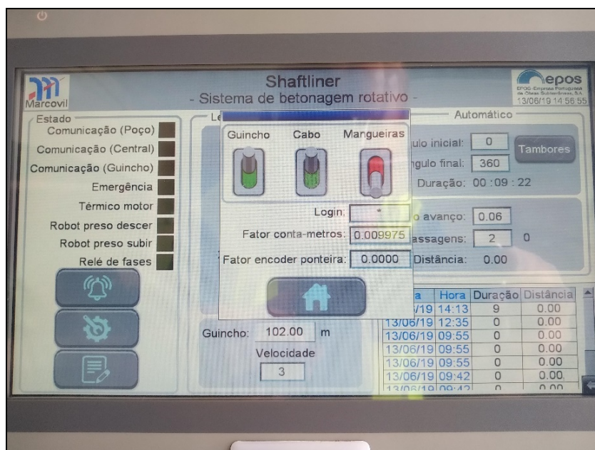
Figura 26. Janela de comando dos enroladores (guincho do cabo de aço, cabo de comunicações e enrolador mangueiras) (adaptado do arquivo de fotos EPOS SA; com autorização).
