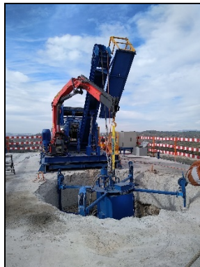
Figura 64. Colocação do robot no interior do poço 4 (arquivo de fotos EPOS SA; com autorização).
