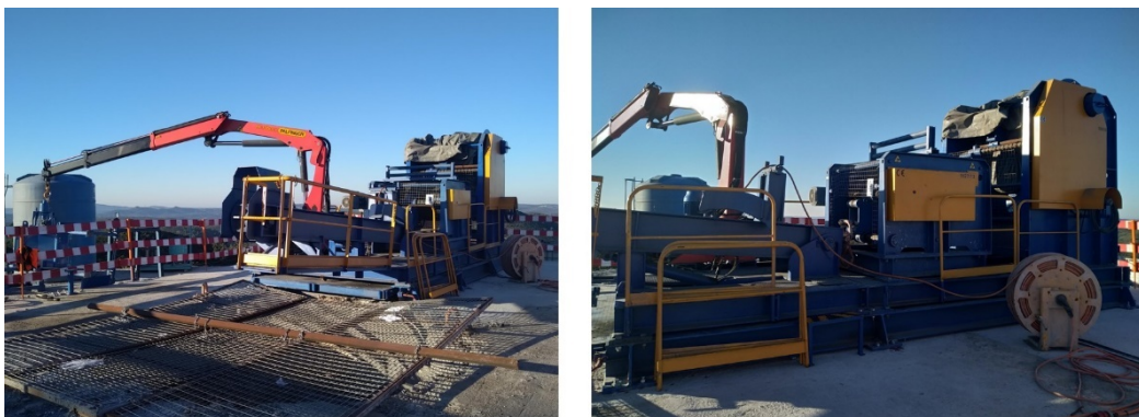
Figura 63. Plataforma técnica montada (arquivo de fotos EPOS SA; com autorização).
