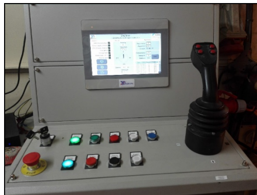
Figura 24. Mesa de controlo do “Shaft Liner” (arquivo de fotos EPOS SA; com autorização).
