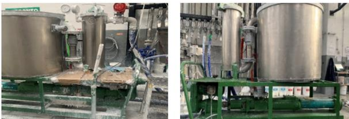
Figura 30 - Antes (imagem da esquerda) e depois (imagem da direita) do aperto do empanque das bombas Netzsch
