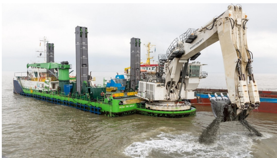
Figura 3 - Draga escavadora pertencente à empresa DEME, sendo a sua designação “Peter the great” ( https://www.deme-group.com/ )
