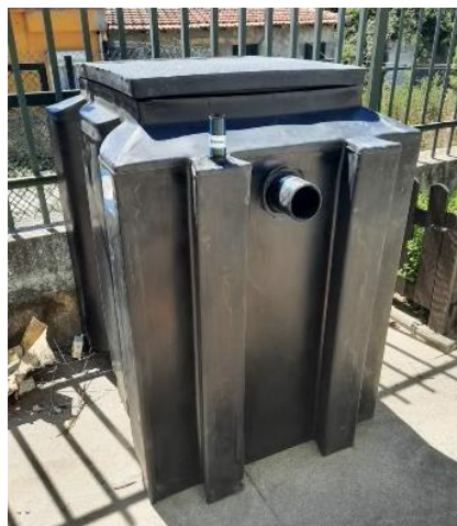
Figura 4.1 – Separador de gorduras.
