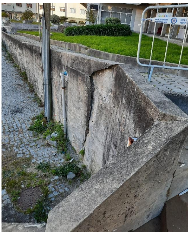
Figura 5.17 – Situação atual do muro de suporte.
