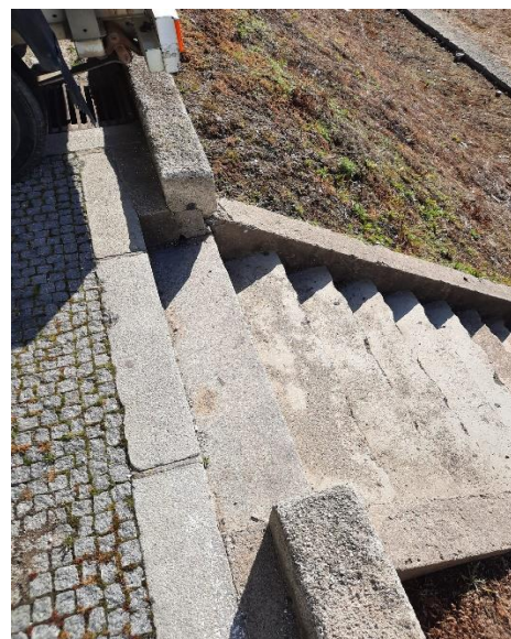
b) Necessidade de prolongar a viga
