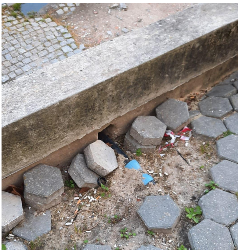
Figura 5.18 – Ramal de água onde ocorreu a fuga.
