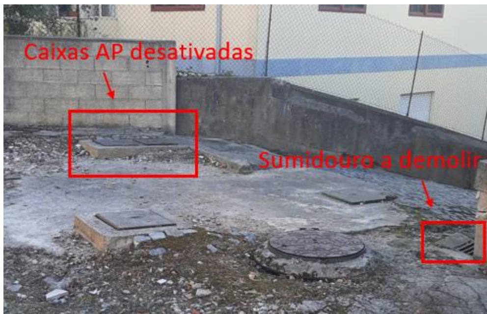
Figura 5.12 – Localização das caixas de águas pluviais desativadas e de um dos sumidouros a demolir.
