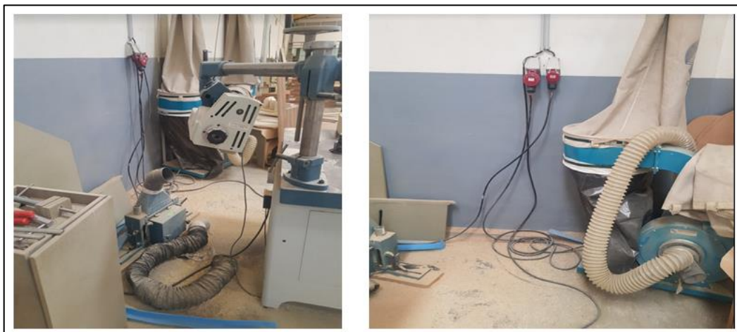
Figura 26. Cabos Elétricos -Marcenaria
