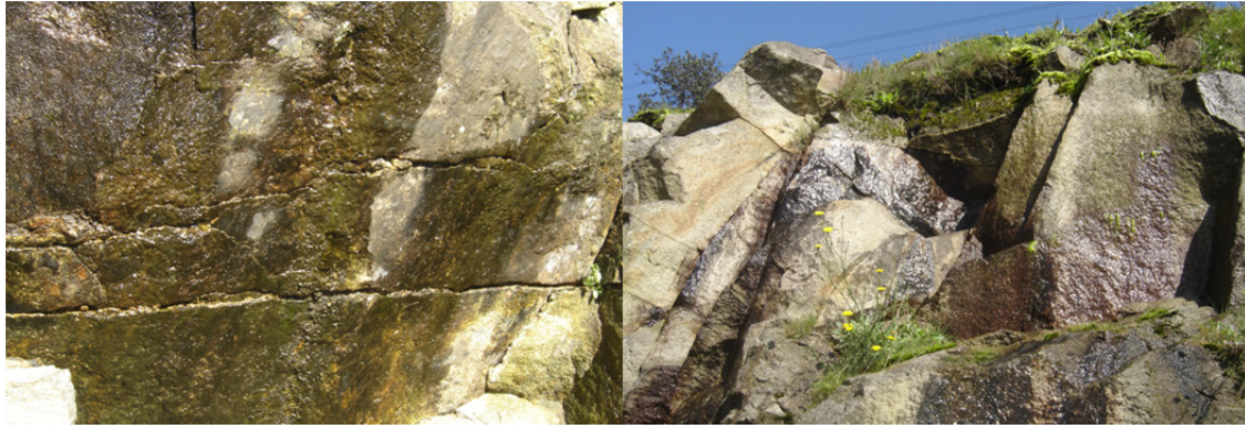
Figura 14. Exemplos da percolação de água nas descontinuidades do maciço rochoso.
