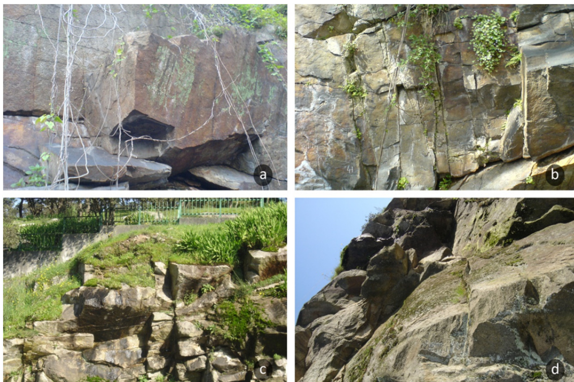
Figura 1. Compartimentação do maciço rochoso. (a) tamanho de blocos; (b) fraturação do maciço; (c) número e orientação das famílias de descontinuidades; (d) grau de alteração.
