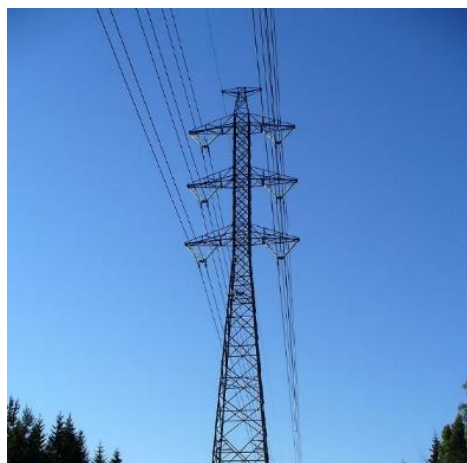
Figura 4 - Torre de alta tensão [10].
