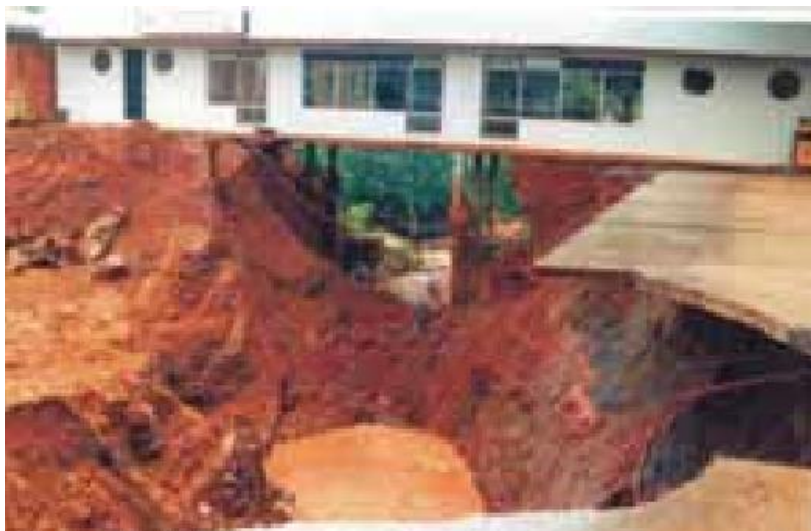
Figura 4.17 - Rompimento de canalização enterrada. (Milititsky, 2015)
