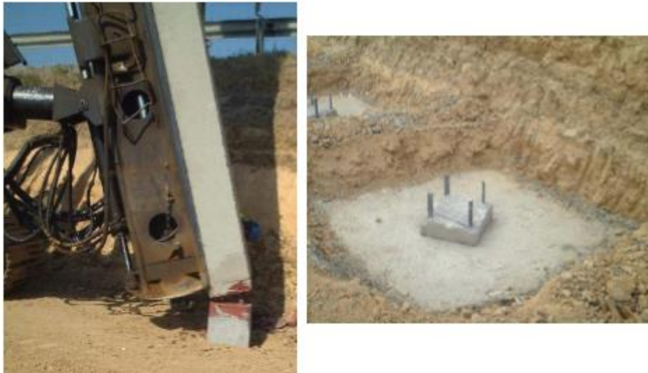
Figura 3.11 - Esquerda: colocação de novo troço de uma estaca pré-fabricada em betão armado; direita: cabeça da estaca e dispositivos de ligação ao maciço de encabeçamento. (Pinto, 2006)
