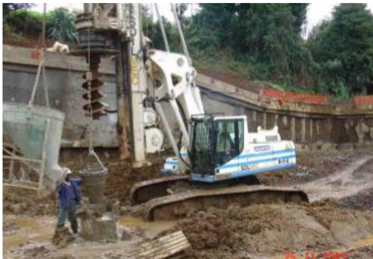
Figura 3.18 - Execução de estaca com extração de terreno e utilizando lamas bentoníticas. (Pinto, 2006)
