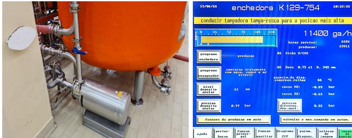
Figura 4. 6 – Bomba centrifuga da linha 3 e HMI da enchedora, respetivamente.
