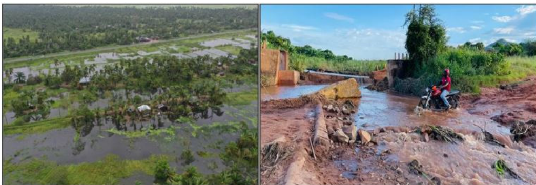
Figura 5. Rastos de inundação e destruição de uma das estradas da província da Zambézia, após passagem do ciclone Freddy em Março de 2023.
