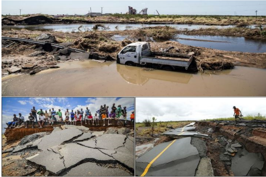
Figura 3. Rastos de destruição da estrada nacional nº 6 (EN6), algures na província de Sofala em Moçambique, após passagem do ciclone Idai em Março de 2019 (Fonte: https://www.publico.pt/2019/03/23/mundo/noticia/estrada-beiramaputo-reabre-domingo-ajuda-vai-comecar-chegar-depressa-1866576 )
