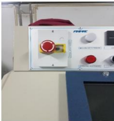
Figura 2-Painel com botão de emergência.
