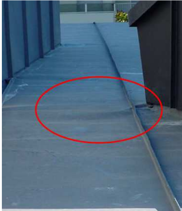
Figura 100 - Empenamento da chapa de zinco
