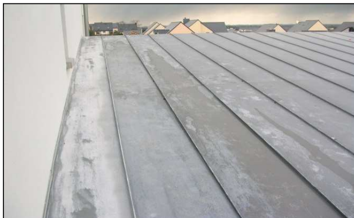
Figura 103 - Manchas provocadas pela contaminação da chapa de zinco
