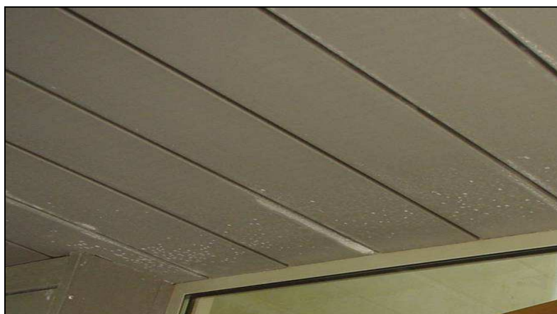
Figura 104 - Manchas provocadas pela contaminação com sal
