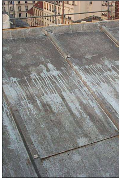
Figura 101 - Manchas brancas provocadas por chuvas ácidas
