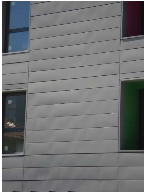
Figura 25 - Aspeto ondulado em fachada
