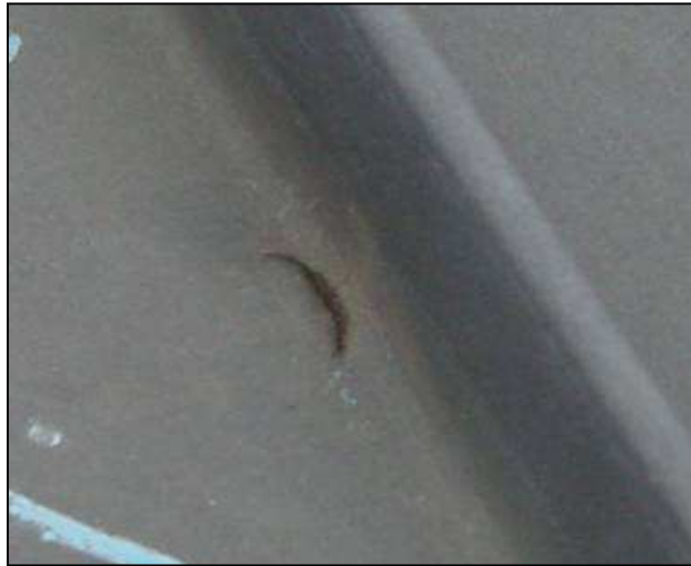
Figura 98 - Fissura na chapa
