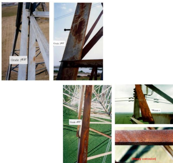
Figura 5. Avaliação dos diferentes níveis de corrosão
