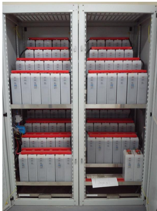
Figura 8 – Armário do grupo de baterias
