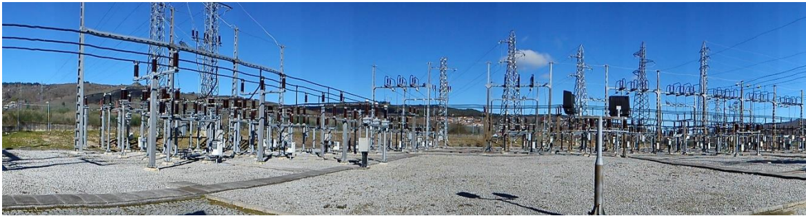
Figura 2 – Subestação AT/MT localizada na freguesia de Soutelo do Douro
