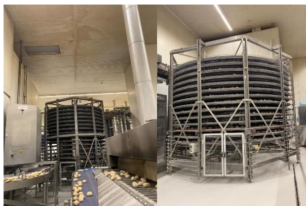
Figura 7 - Torre de Arrefecimento
