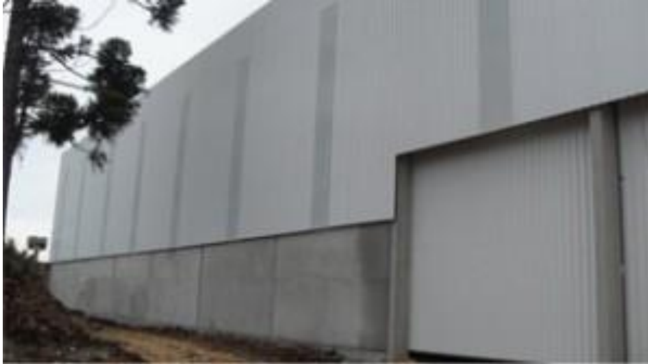
Figura 43 - Armazém com estrutura pré-fabricada revestida com painéis de betão e chapa metálica [23]
