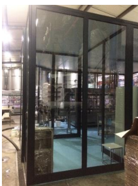
Figura xxi. Vista traseira da zona da antecâmara. Existência dos ralos para onde a água da lavagem das mãos irá ser enviada, na zona do chão, à esquerda. Para além disso estão também vislumbradas a traseira do lavatório de pé, o banco de apoio e uma parte do cacifo.
