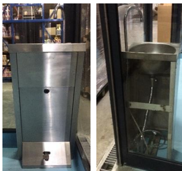
Figura xxviii. Vista frontal e traseira do lavatório em inox presente na antecâmara da sala branca. Os ralos que recebem as águas das lavagens das mãos são visíveis na parte esquerda da figura do lado direito.
