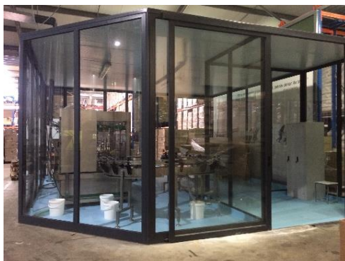
Figura xx. Vista frontal da estrutura da sala branca. Nesta imagem é possível observar a máquina de enchimento à esquerda, a porta de correr P1 que serve de entrada para a sala, o compartimento reservado para a zona da antecâmara à direita e dentro deste um cacifo e um banco de apoio.
