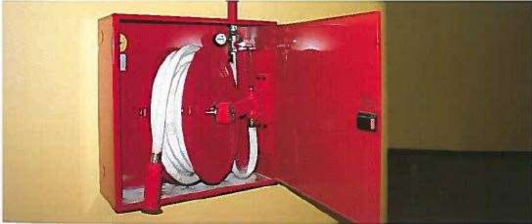
Figura 24. Carretel de incêndio em armário [10]
