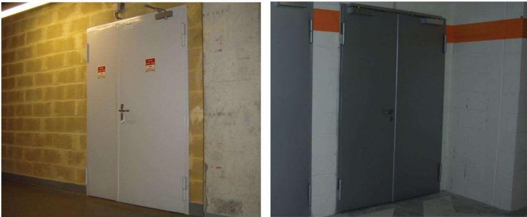
Figura 47. Portas resistentes ao fogo [29]
