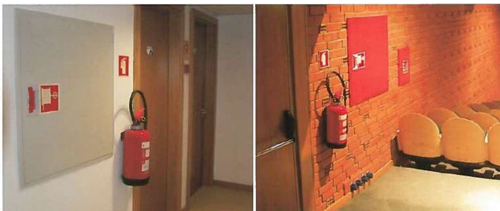
Figura 51. Sinalização de equipamentos [10]
