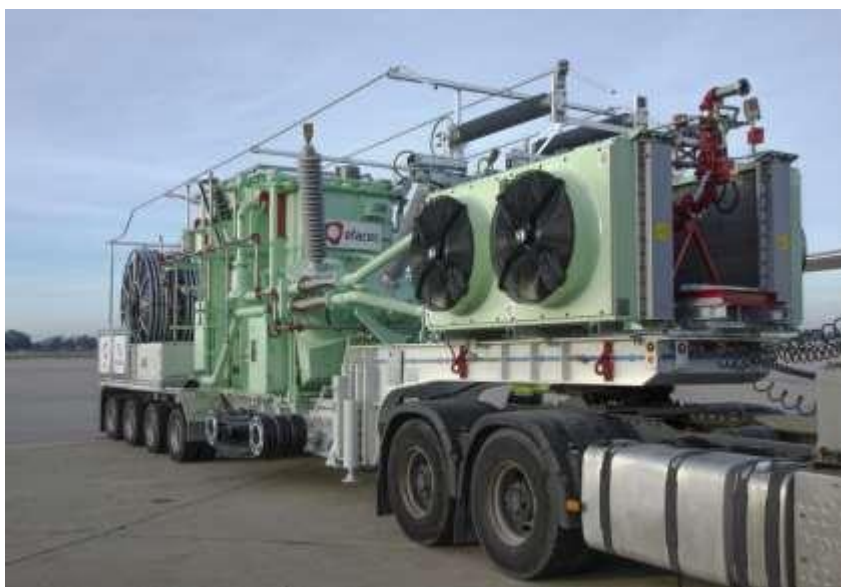
Figura 1 - Subestação movel EFACEC [19]
