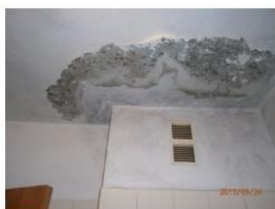
Figura 2.6-Mancha de Humidade interior [6]
