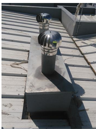
Figura 2.15- Acessórios de ventilação [Foto tirada em obra]
