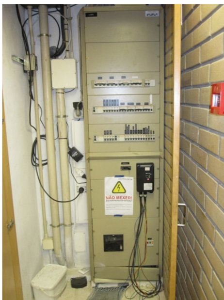
Figura 2.13 – Analisador de energia conectado ao quadro geral do edifício.
