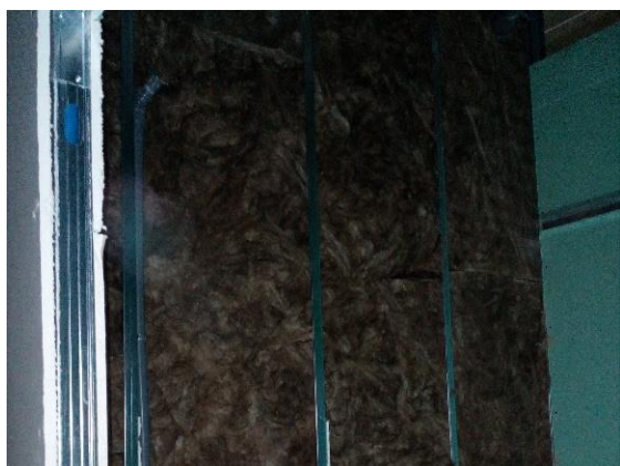
c) Introdução das camadas de lã de rocha por entre a estrutura.
