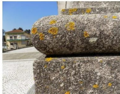
Figura 12 - Acumulação de musgos e vegetação parasitária ou colonização biológica na base da torre sineira em granito a sul
