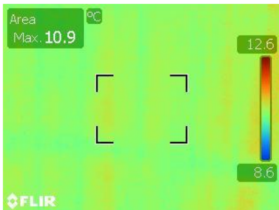
a) Imagem termográfica da zona da parede
