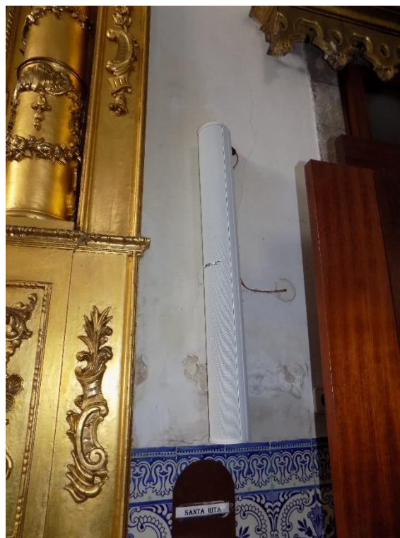
b) Destacamento de tinta
