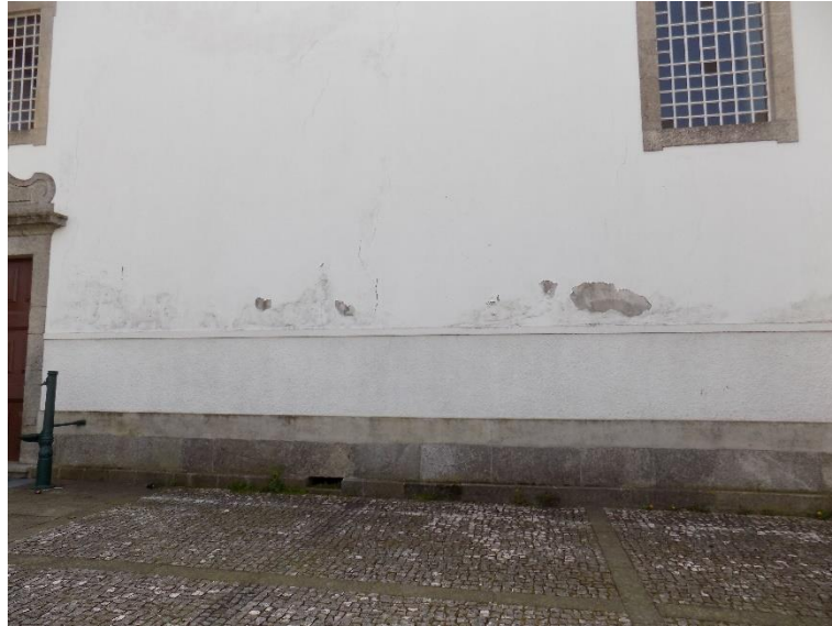
Figura 4.6.1 - Aparecimento de sais por ascensão de água por capilaridade junto do nível acima da camada de emboço
