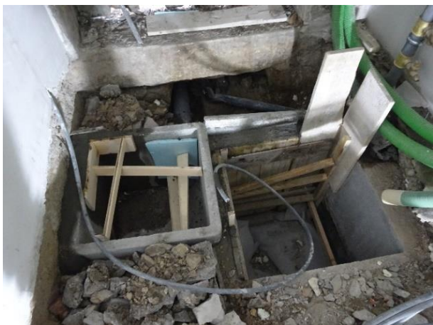
a) Execução de câmaras de visita de drenagem de águas residuais e pluviais
