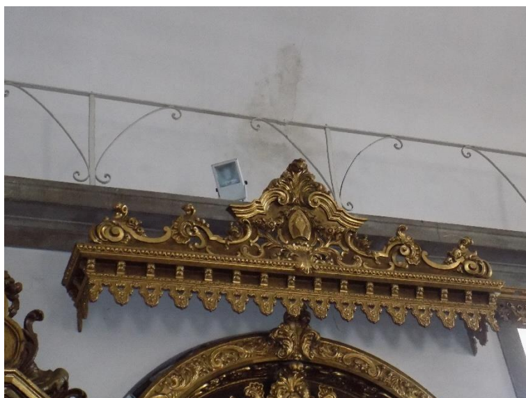
Figura 4.6.3 - Fachada lateral orientada a nascente a apresentar manchas de humidade
