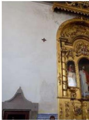
Figura 13 - Manchas de humidade devido a infiltrações na cobertura e ascensão da água por capilaridade, a parede orientada a norte, apresenta-se húmida ao toque
