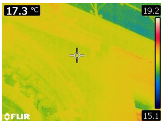
c) Imagem termográfica junto a um altar, na face interior da fachada lateral norte
