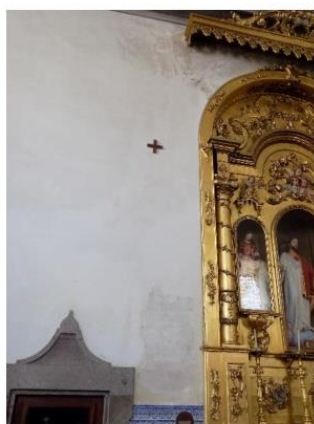
Figura 13 - Manchas de humidade devido a infiltrações na cobertura e ascensão da água por capilaridade, a parede orientada a norte, apresenta-se húmida ao toque
