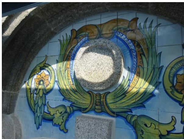
f) Limpeza, restauro e replicação de azulejos pintados à mão da fachada principal
