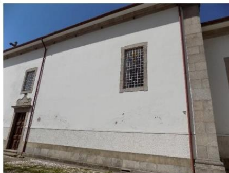
Figura 11 - Empolamento e destacamento do revestimento exterior orientado a sul
