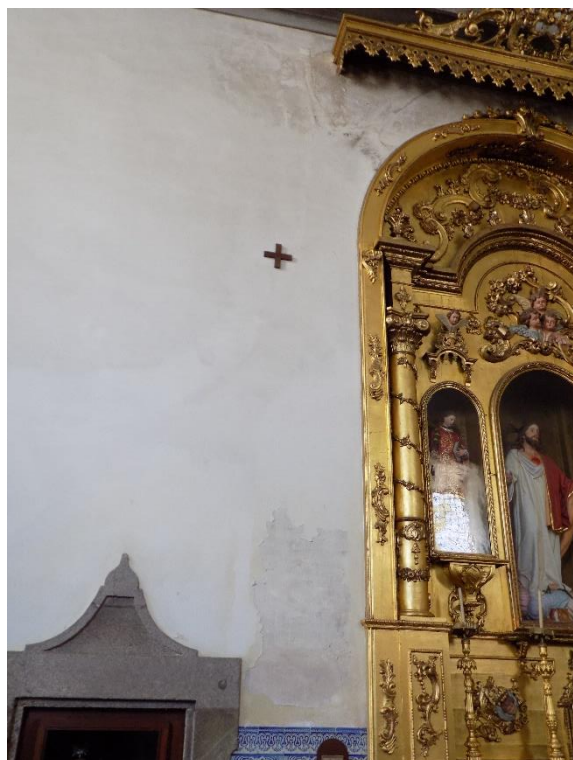
a) Manchas de humidade
