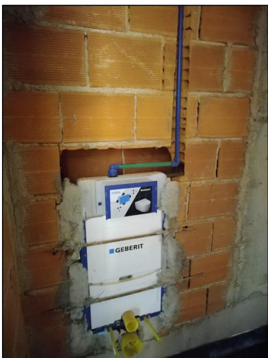
a) Pormenor de abastecimento de água a um dispositivo de autoclismo.
