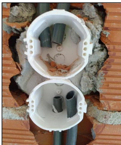
a) Pormenor de tubagens elétricas (“isogris”) nas caixas de tomadas de usos gerais.
