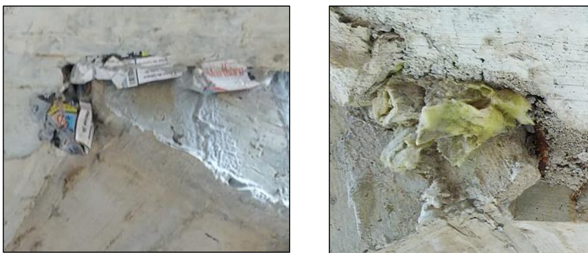
Figura 3.67 – Não conformidades nas escadas (2), (autor).
