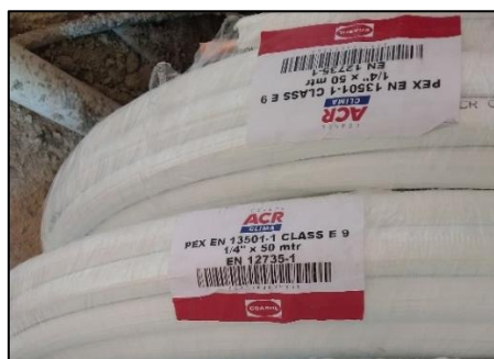
e) Pormenor de norma em tubagens de AC.
