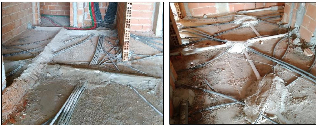
a) Pormenor de tubagens de aspiração central cravadas
