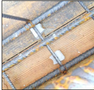
Figura 3.73 – Espaçadores colocados erradamente (autor).
