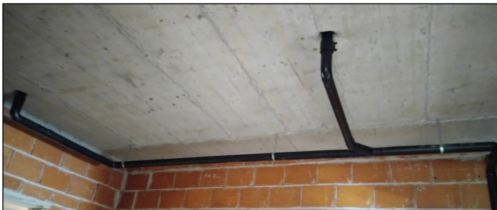
Figura 3.42 – Pormenor de tubagens de drenagem de AP entre cobertura e quinto piso (autor).
