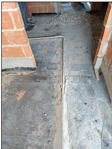
a) Pormenor de tubagem no chão
