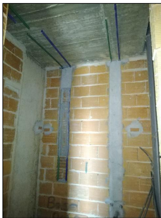
b) Pormenor de abastecimento de água – tubagens nas paredes.
