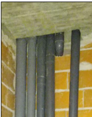
a) Tubagens de extração de ar no segundo piso.
