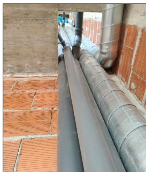
b) Pormenor de tubagens de exaustão de cozinhas na courette.
