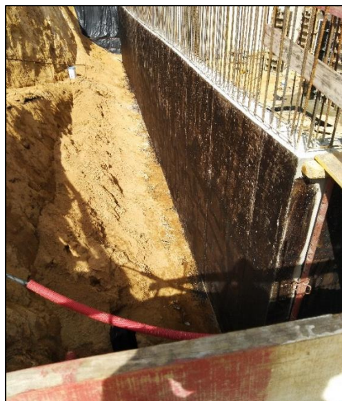
b) Pormenor de aplicação de emulsão betuminosa na face exterior de muros de suporte
