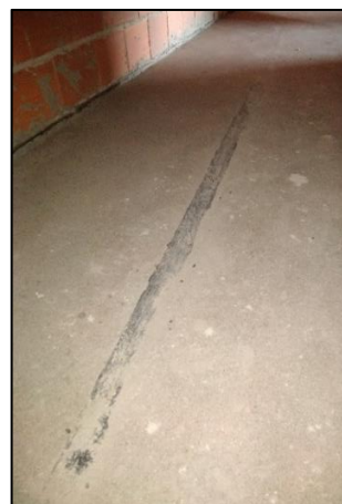
b) Pormenor de erro de execução durante a cravagem das tubagens ou da sua posterior danificação e não deteção.
