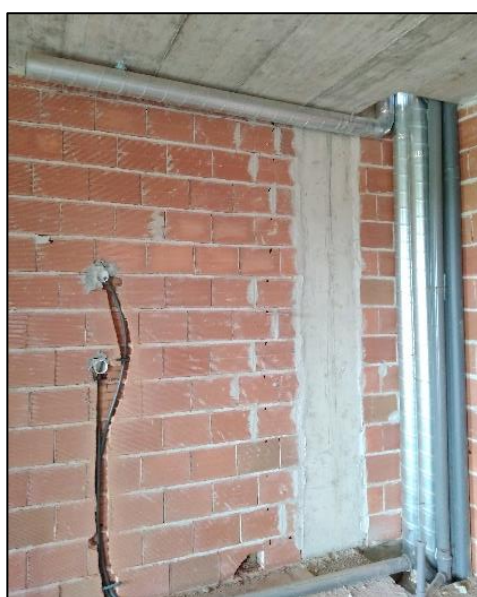
a) Pormenor de tubagens de exaustão de cozinhas.
