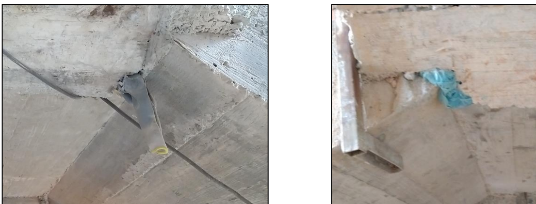
Figura 3.66 – Não conformidades nas escadas (1) (autor).
