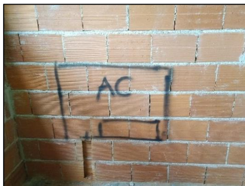
a) Marcação de equipamentos – unidade de climatização interior
