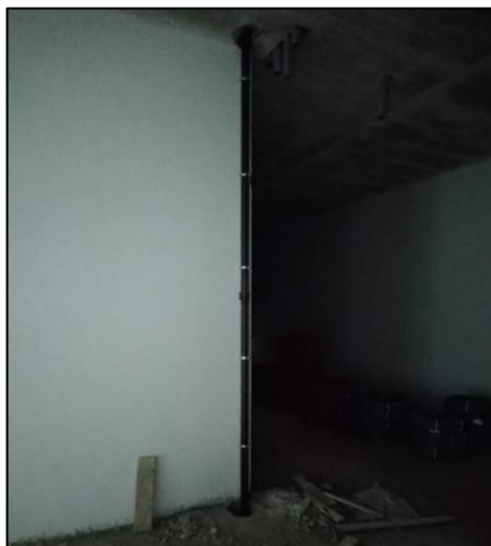
Figura 3.43 – Pormenor de tubagem de drenagem de AP no piso -1 (autor).
