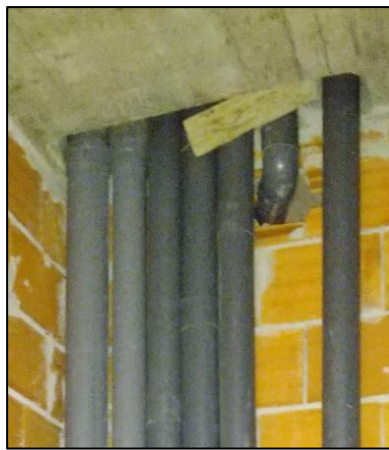
b) Tubagens de extração de ar no terceiro piso.
