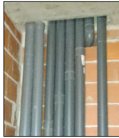
c) Tubagens de extração de ar no quarto piso.
