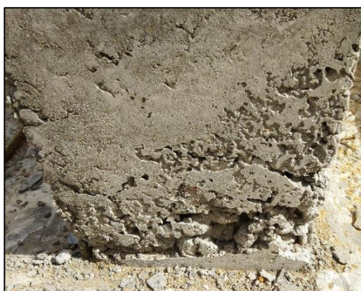
a) Pormenor de NC no pilar
