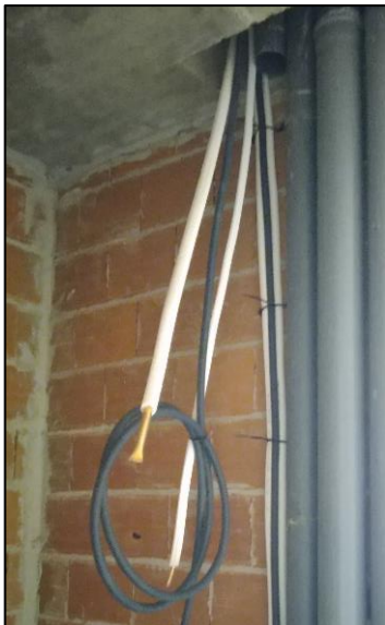
a) Pormenor de passagem de tubagens de unidade de AC pela courette.
