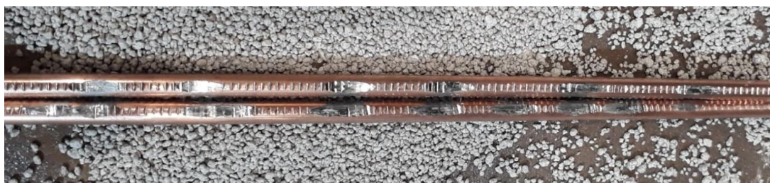
Figura 38 – Fio de soldadura danificado
