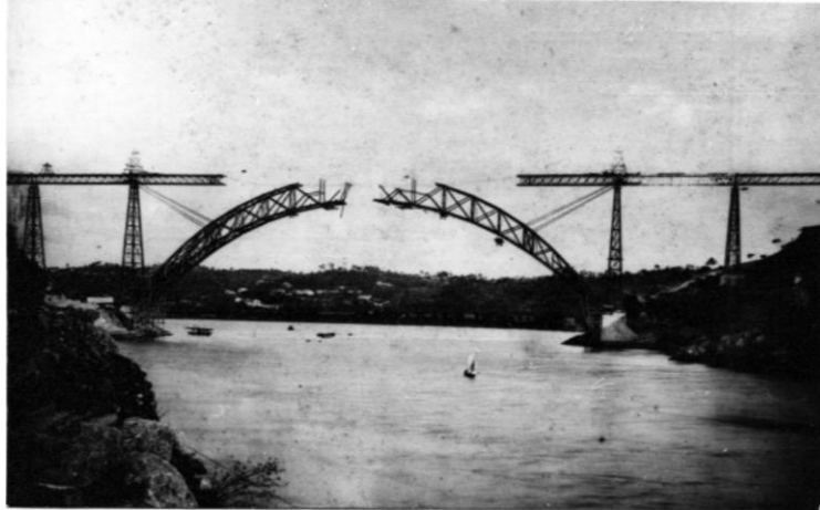
Figura 69 – Construção da Ponte de D. Maria Pia, 187? (Fonte: Arquivo Municipal do Porto)
