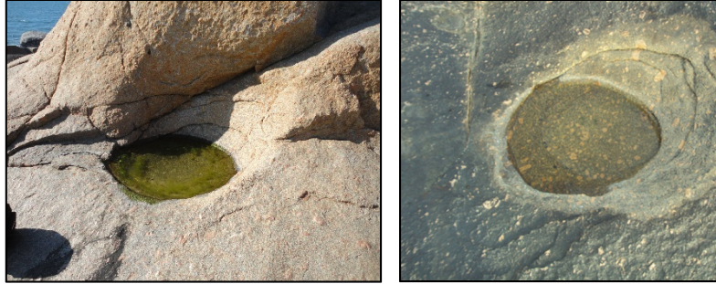
Figura 5.39 – Exemplos de exfoliação do granito.
