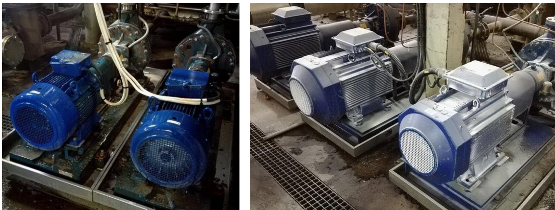
Figura 4.2. Motores responsáveis pelas filtrações do processo, 1ª filtração e filtração Putsch, respetivamente
