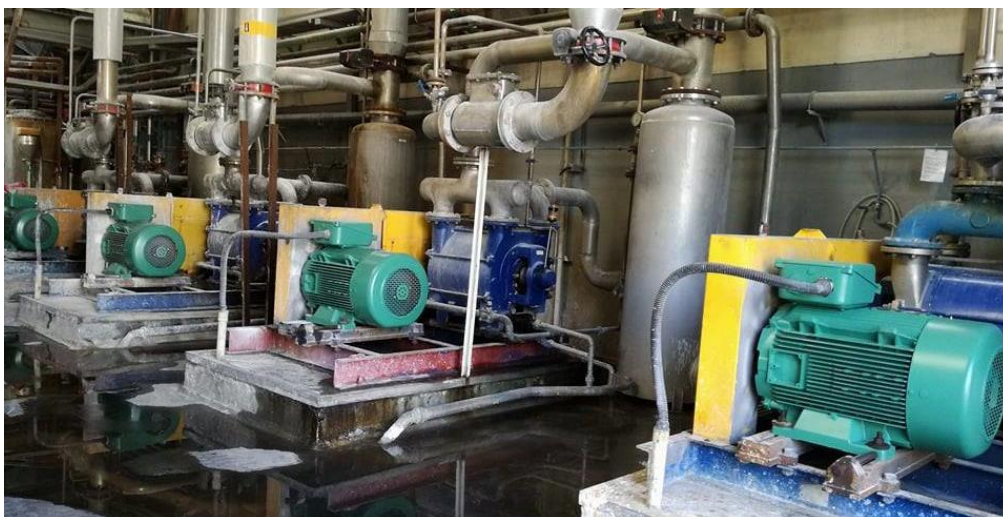
Figura 4.6. Motores elétricos dos compressores de gás
