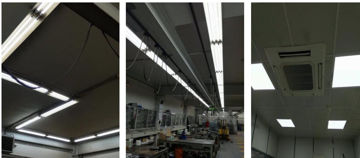
Figura 4.16. Iluminação tubular LED e painéis LED
