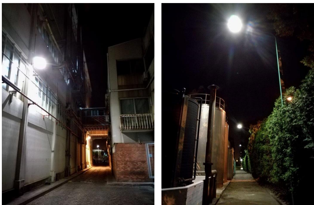
Figura 4.17. Iluminação LED exterior
