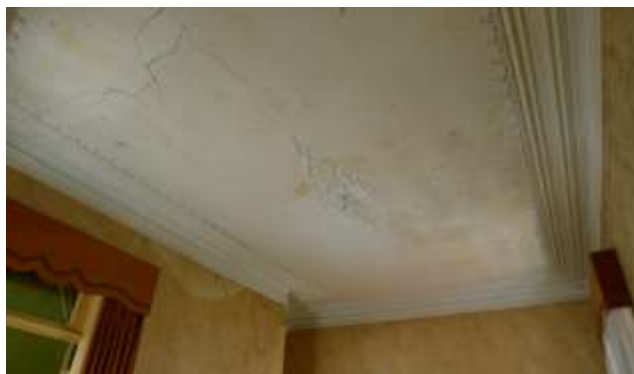
Figura 4.8 – Teto em gesso degradado
