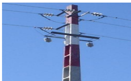
Figura 18. Sinalização num apoio [13]
