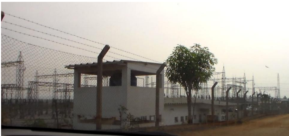
Subestação Uíge I
