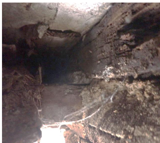
c) Rotura de viga de madeira
