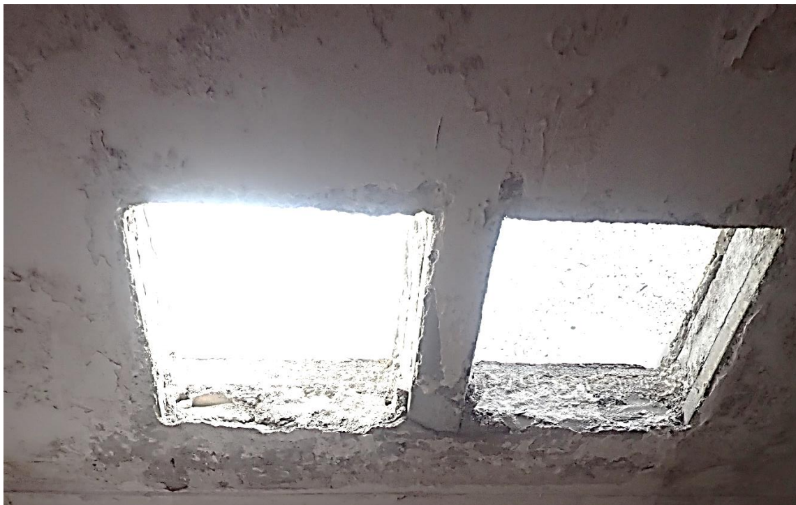
a) Manchas de humidade na face inferior da laje aligeirada
