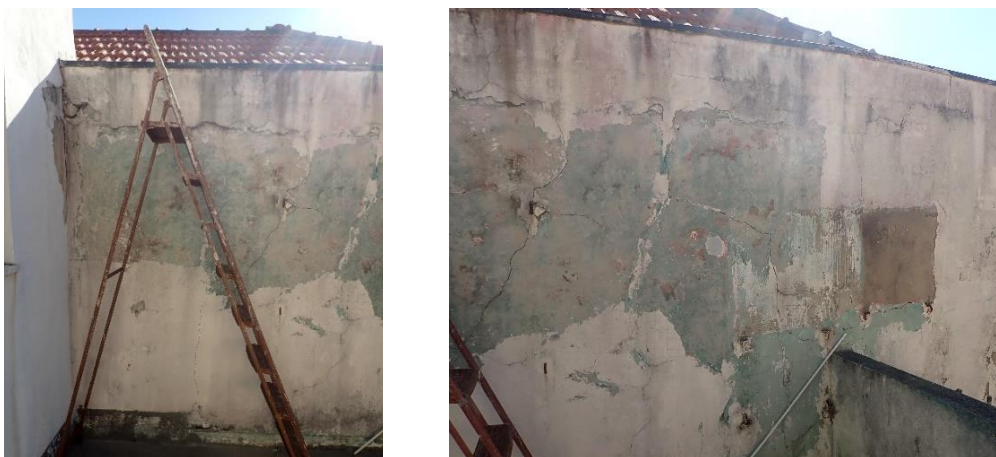
Figura 4.10 - Degradação do reboco de revestimento da parede de alvenaria lateral Sul do terraço com fissuração associada
