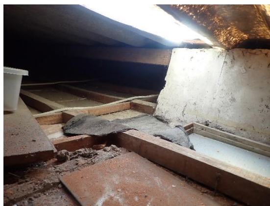
d) Estrutura de madeira não qualificada do tecto do piso 1
