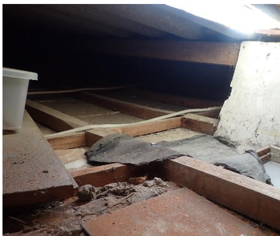
a) Estrutura de suporte, não qualificada
