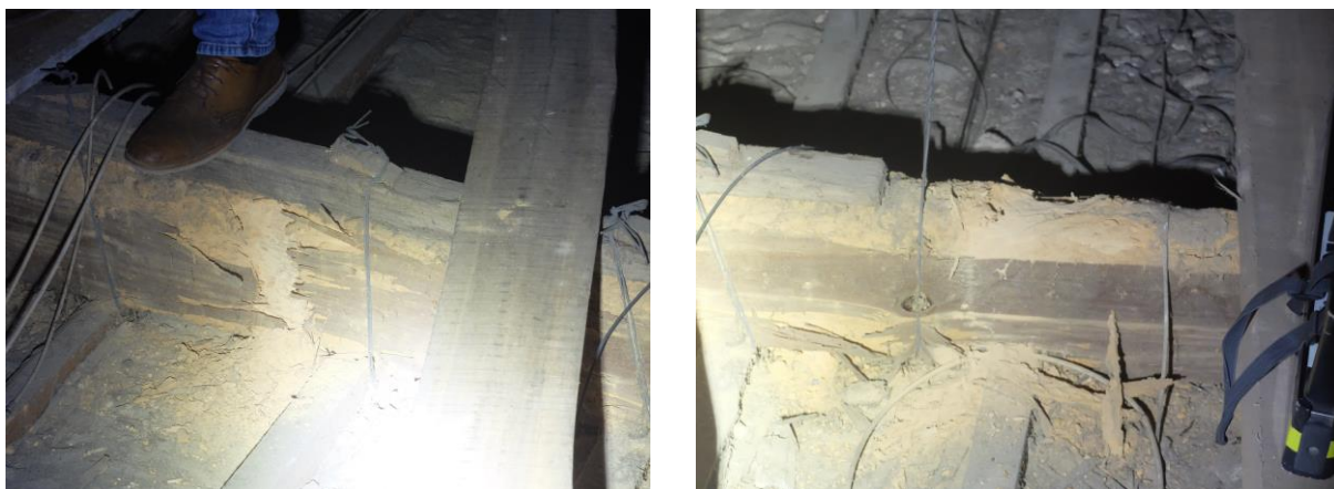
Figura 5.8 - Ataque de caruncho, vigas de suporte de teto
