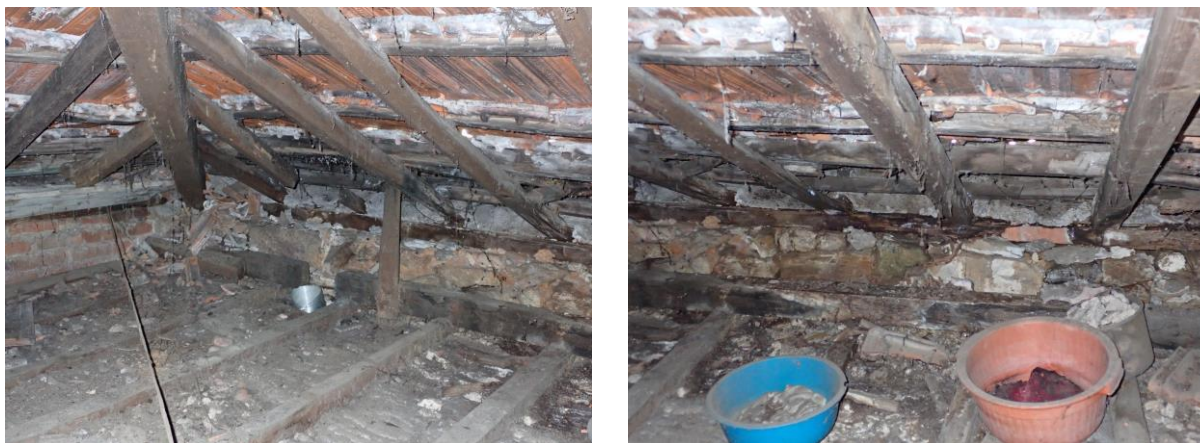
Figura 5.7 - Entrada de água junto ao frechal, degradação dos elementos estruturais
