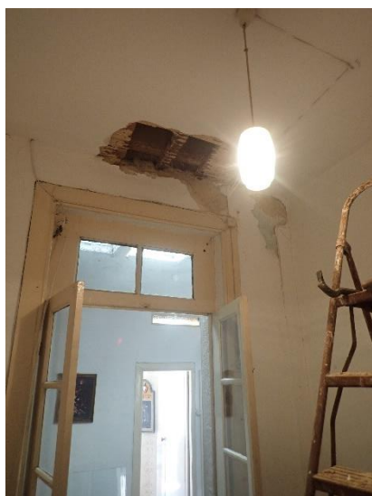
a) Abertura de uma janela de sondagem no tecto do piso 1 para inspeção do pavimento
