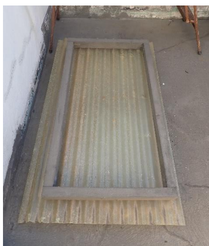
b) Ineficaz isolamento das aberturas na laje
