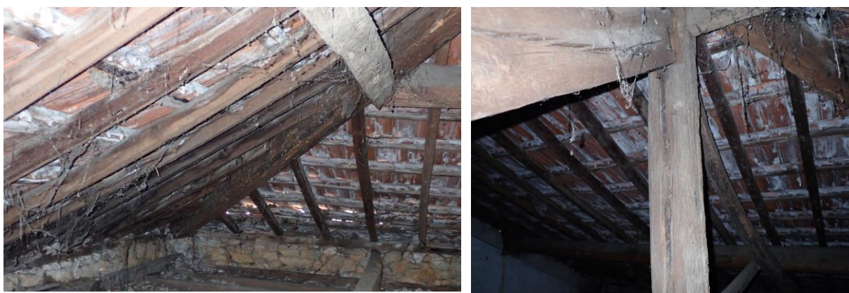
a) Deformação das águas do telhado
