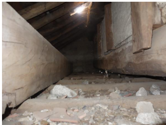
c) Espaço 2, é possível ver paredes verticais e estruturas de suporte horizontal da mansarda
