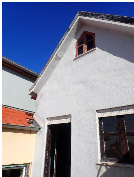
a) Parede de alvenaria de pedra da fachada de tardoz (pisos 2 e 3)
