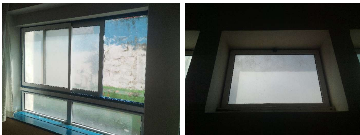
a) Janela 1 (salas de aula).
