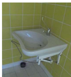
e) Lavatórios s/ temporizador.
