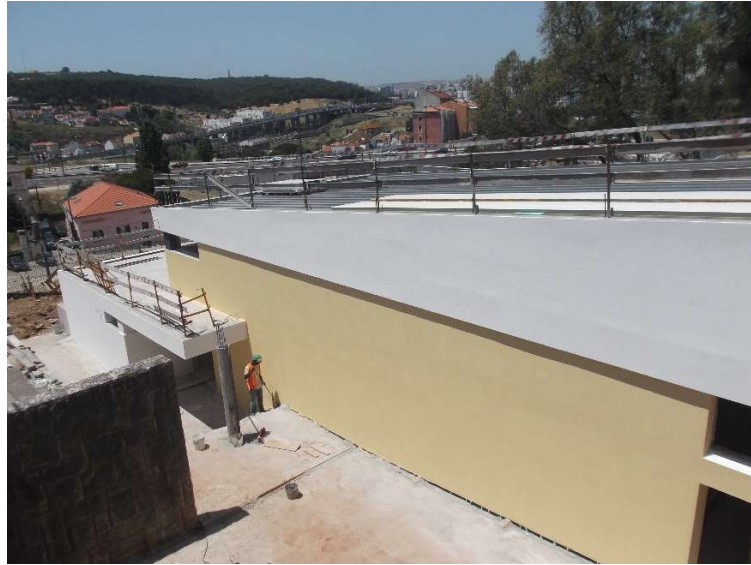
Figura 3.53 – ETICS do pavilhão gimnodesportivo.
