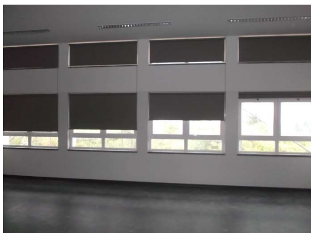
a) Janela 1 (salas de aula).
