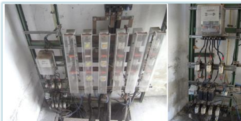
Figura 54 – Quadro Geral Baixa Tensão do PT12
