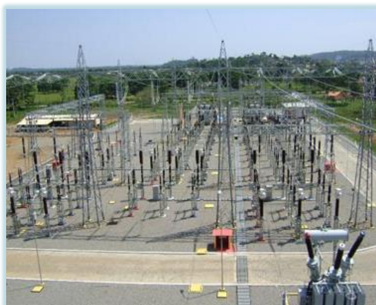
Figura 6 – Exemplo de uma Subestação a céu aberto
