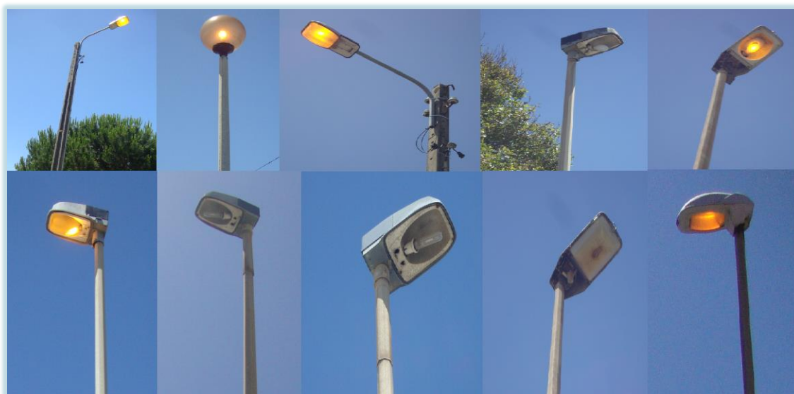
Figura 57 – Luminárias do PT 12
