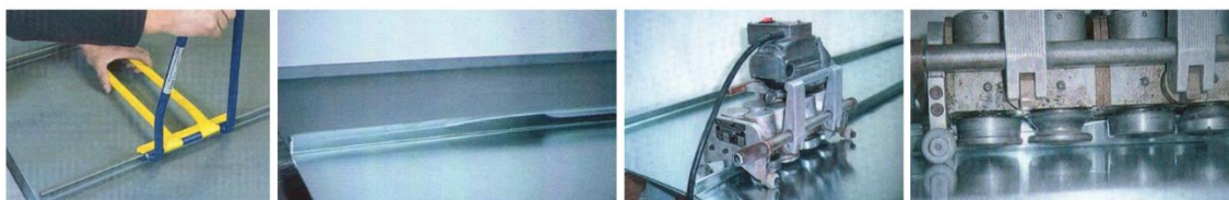
Figura 21 – Etapas do fecho das nervuras das placas de revestimento – Sistema Junta agrafada
