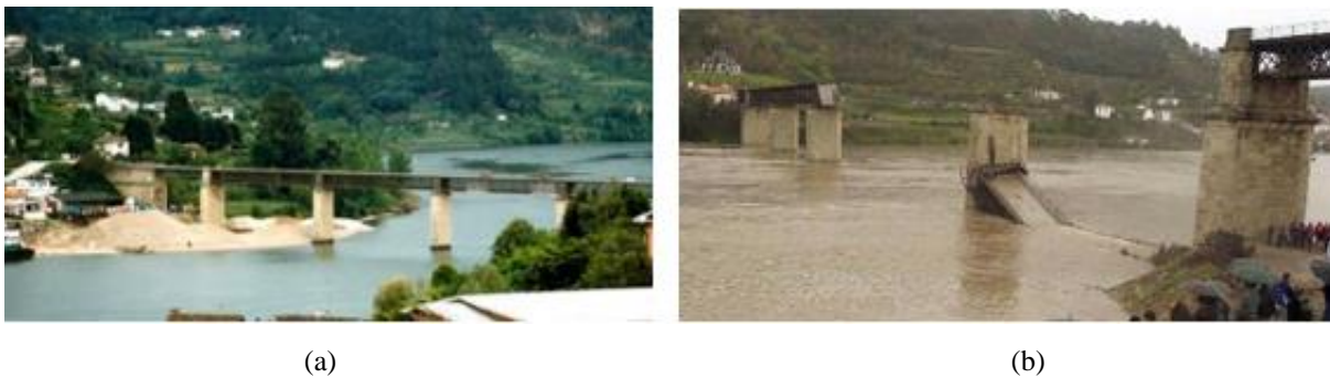
Figura 1.1 - Ponte Hintze Ribeiro em Entre-os-Rios - Portugal: (a) antes do colapso; (b) após o colapso, ocorrido em (2001), provocando 59 mortos (Rodrigues, 2011).
