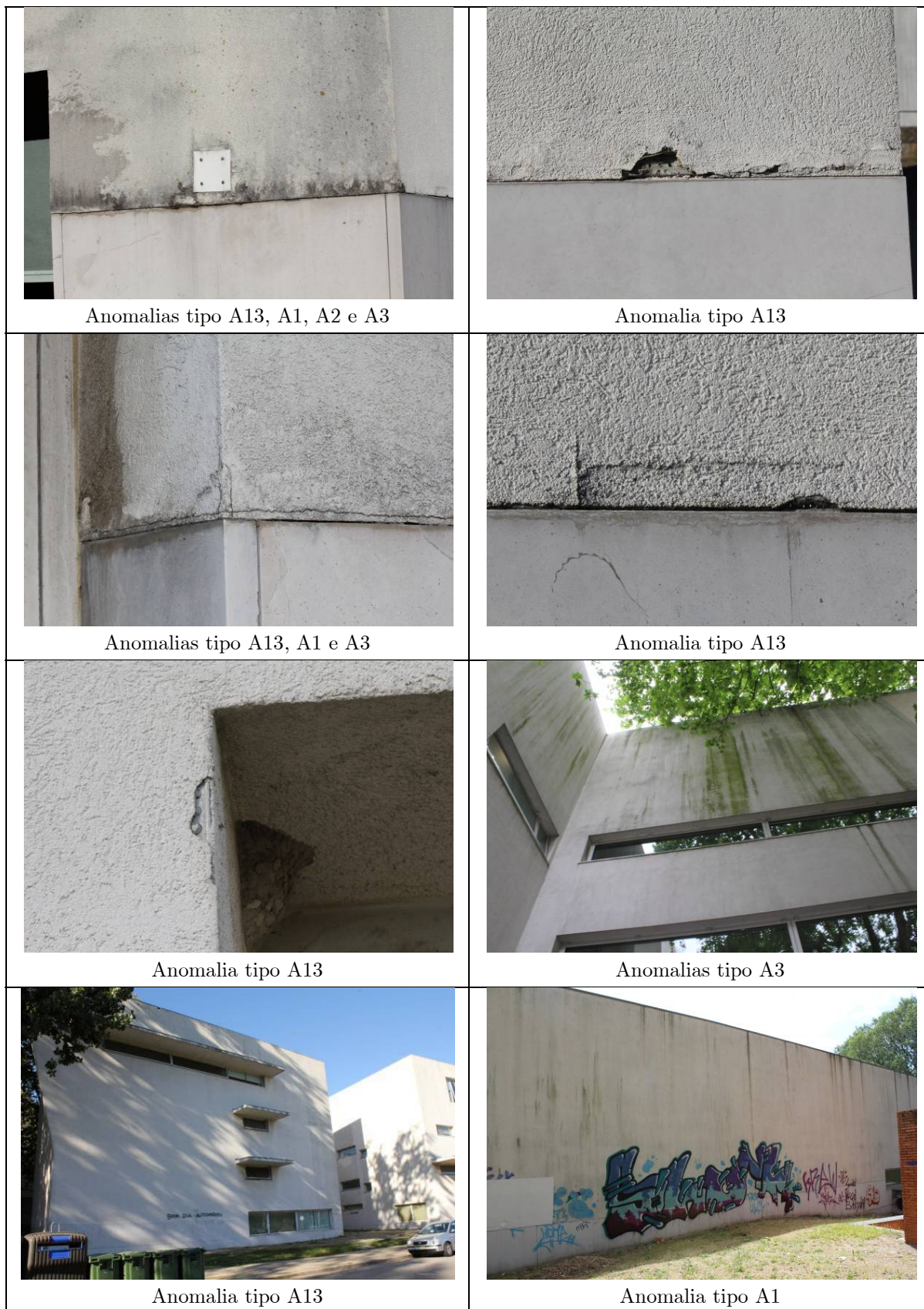
Figura 4.3 – Exemplos de anomalias observadas nos edifícios da FAUP (continuação).
