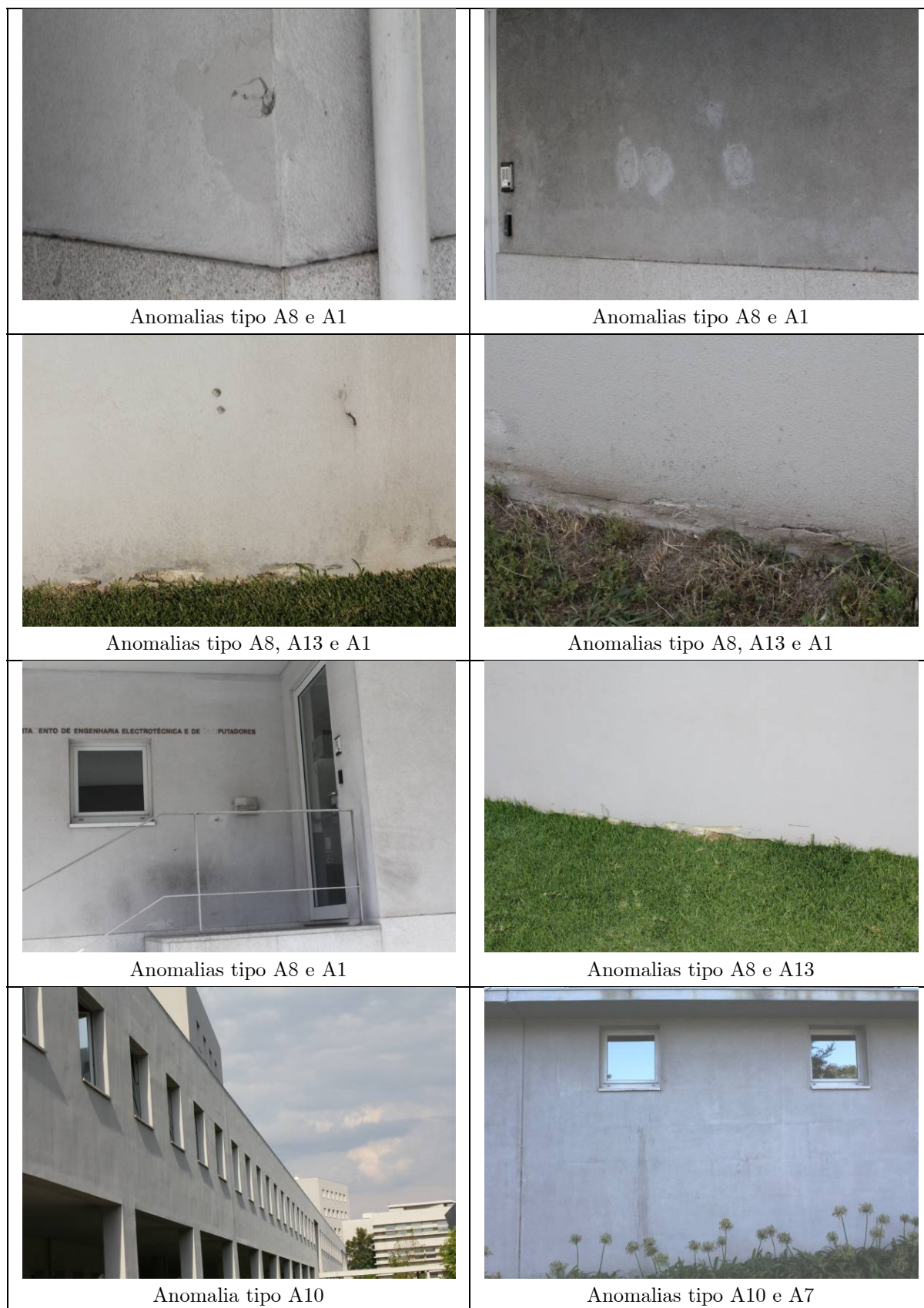
Figura 4.14 – Exemplos de anomalias observadas nos edifícios da FEUP (continuação).
