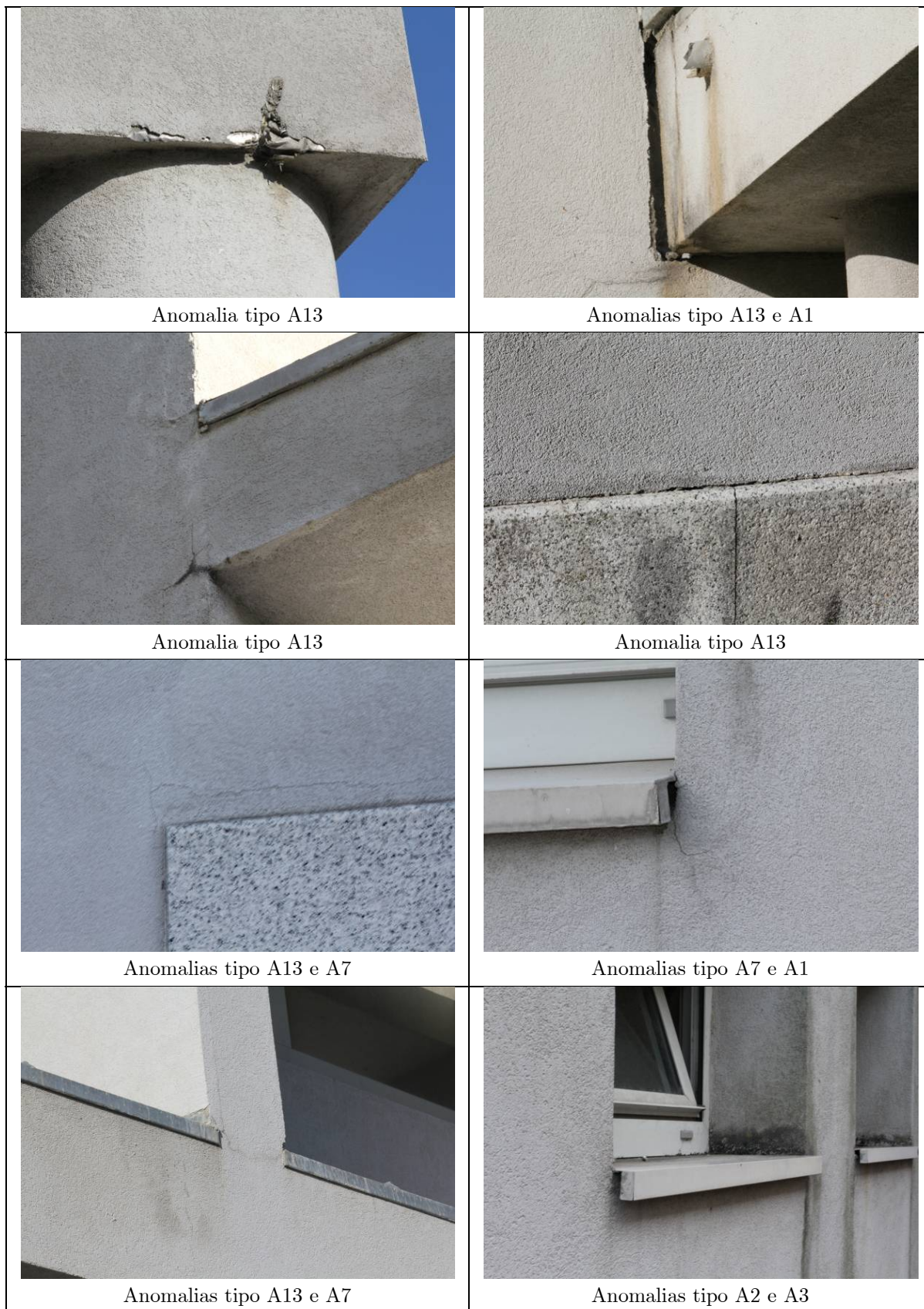
Figura 4.14 – Exemplos de anomalias observadas nos edifícios da FEUP
