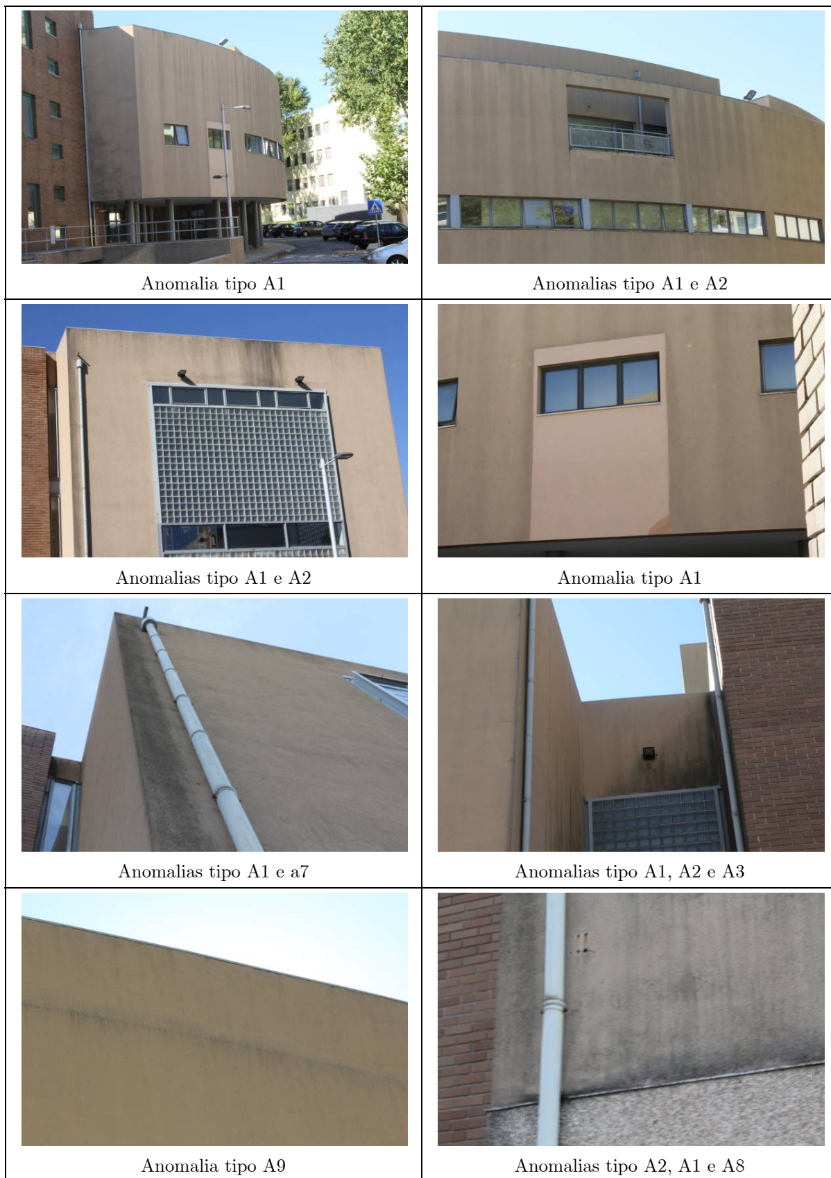
Figura 4.25 – Exemplos de anomalias observadas nos edifícios do ISEP.
