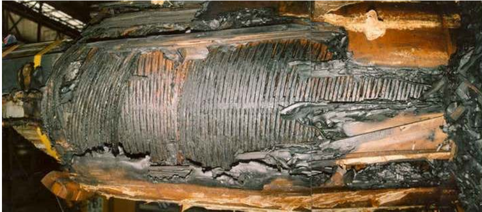
Figura 6 – Enrolamentos de um transformador seco danificado
