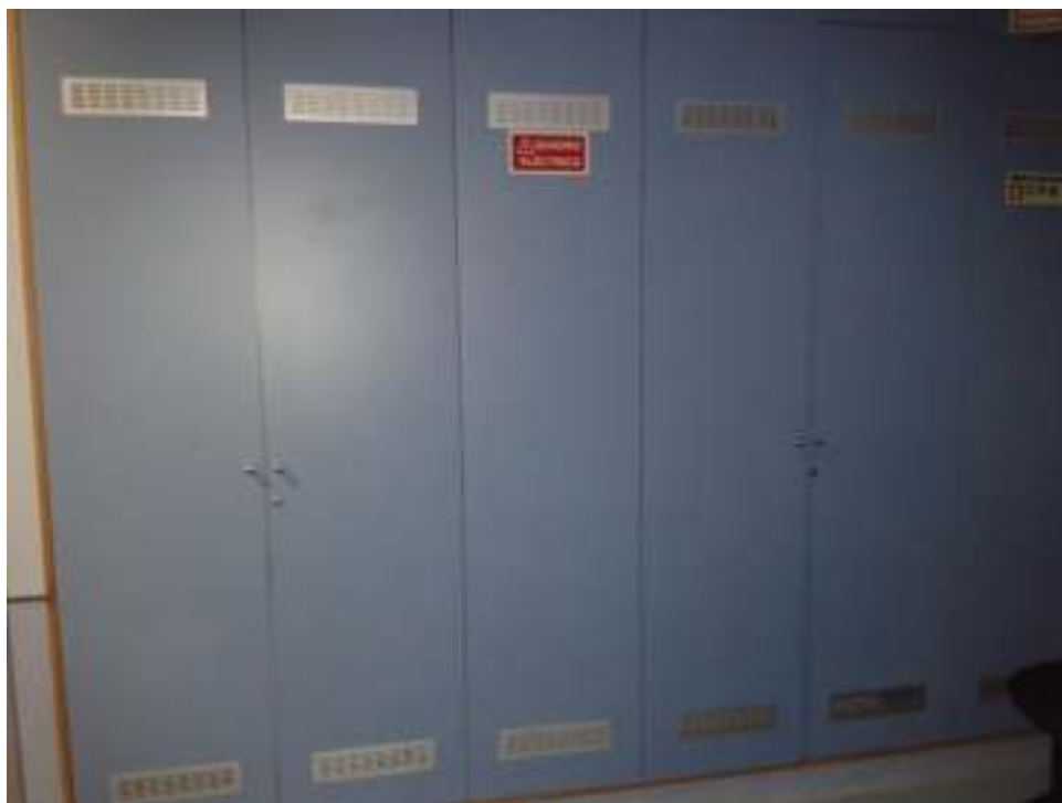
Figura 11 - Quadro elétrico com ventilação natural implementada
