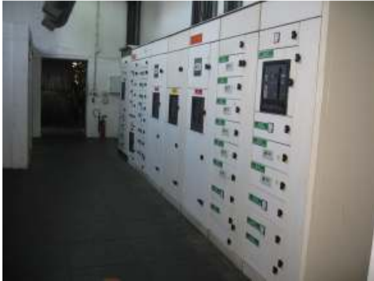
Figura 23 - Posto de Transformação de uma instalação industrial
