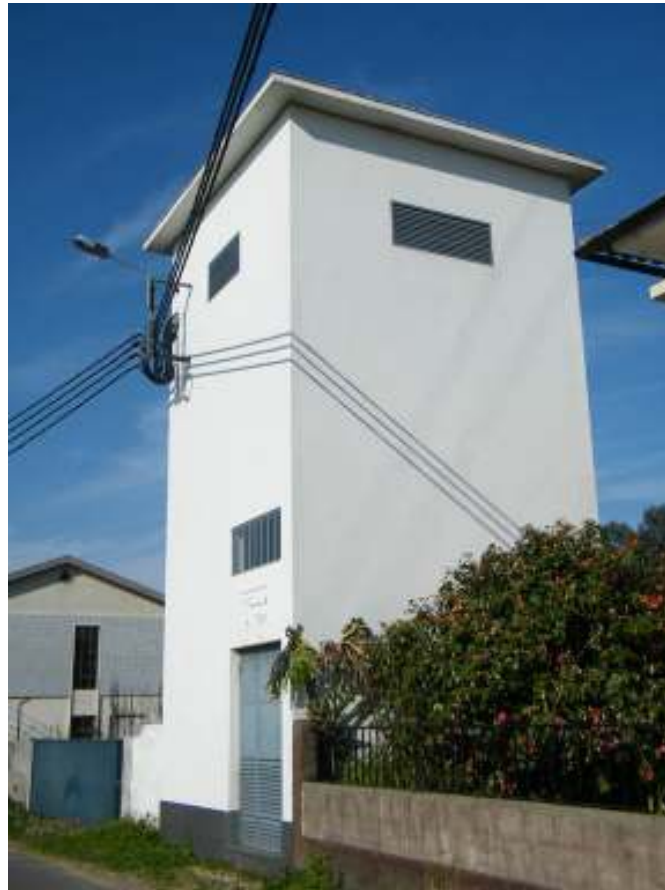
Figura 22 - Posto de transformação do tipo cabina alta
