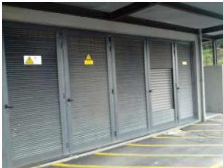
Figura 28 - Vista exterior de uma sala de grupo gerador
