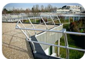
Não acessível (exceto a trabalhos de reparação e manutenção)
