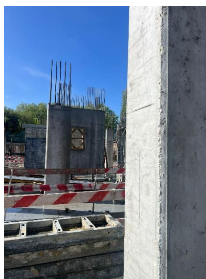
Figura 42 - Quebra-cantos em pilares
